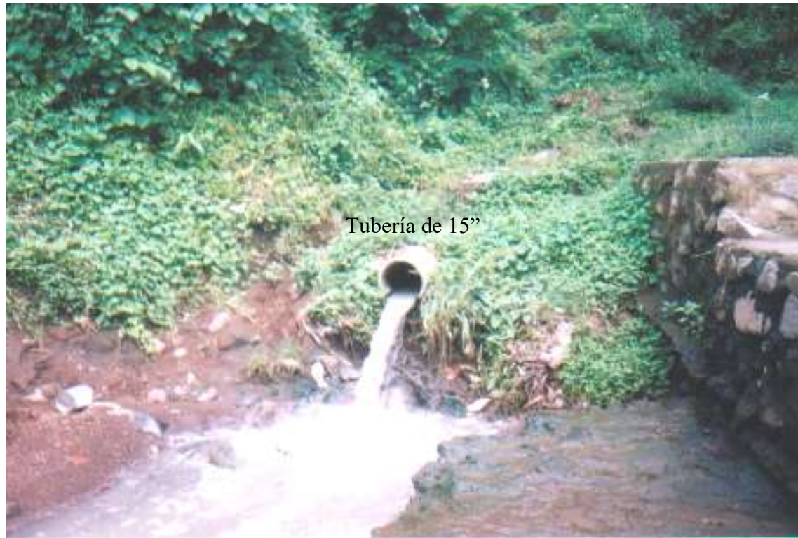
Fig. 2: Punto donde descargan las aguas residuales con tubería de 15" de diámetro de concreto reforzado.
