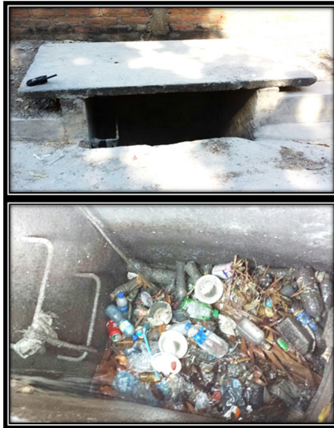
Imagen 36. Tragante 5 sin rejillas con basura acumulada.
