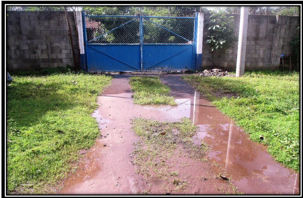
Imagen 7. Estancamiento de aguas lluvias.
