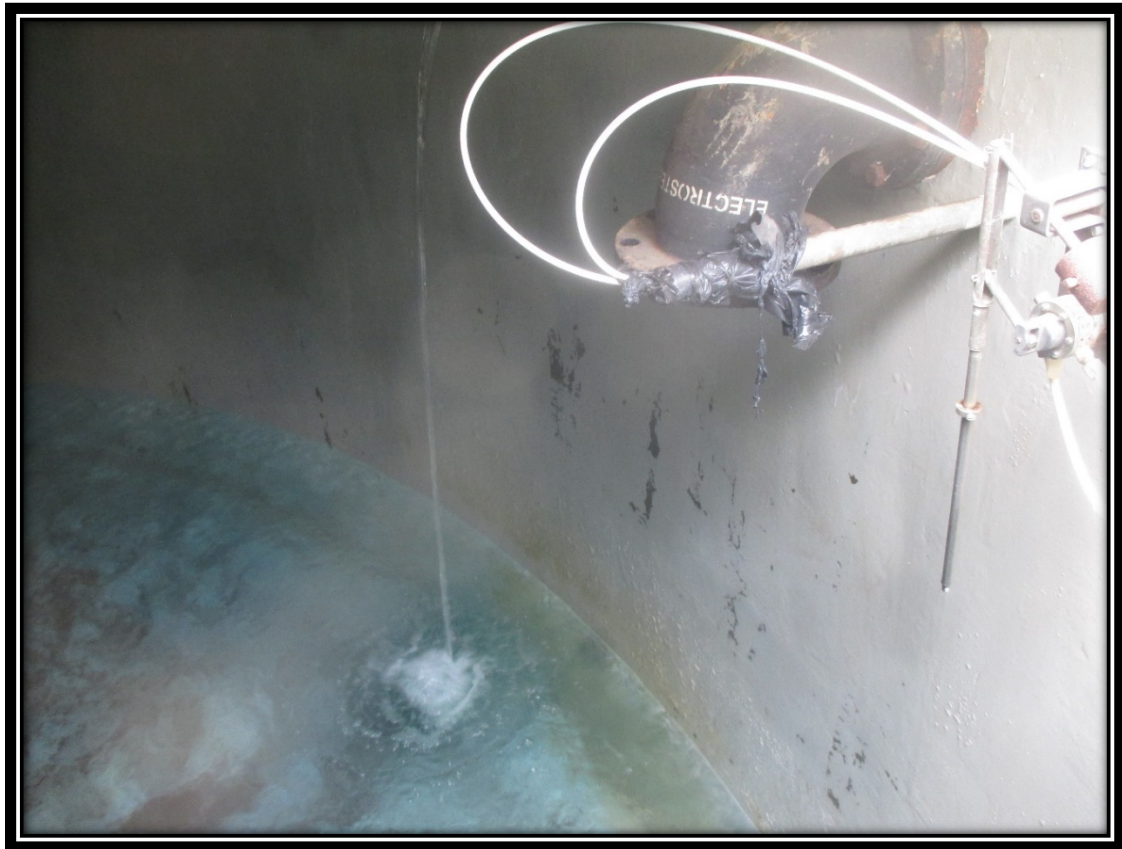
Imagen 14. Ingreso de agua al tanque de almacenamiento.
