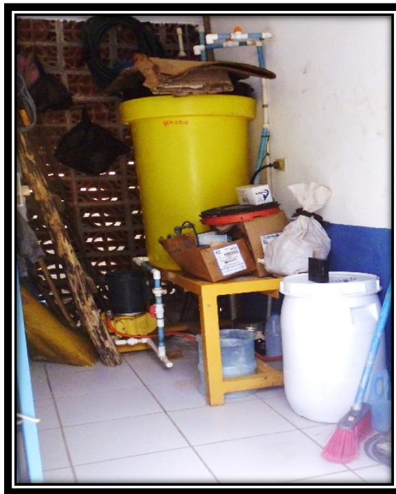
Imagen 17. Equipo de cloración (electromecánico).
