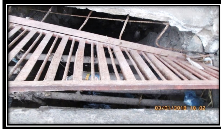
Imagen 32. Tragante 3 en malas condiciones
