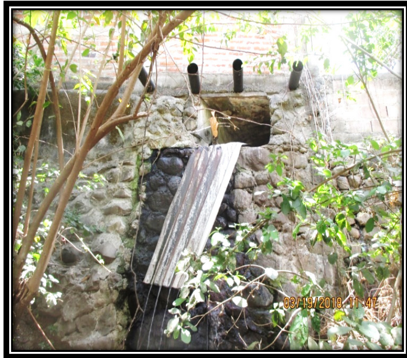
Imagen 34. Salida de las aguas grises de tragante
