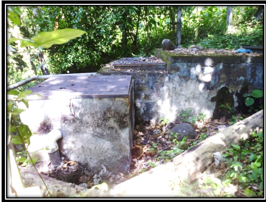
Imagen 21. Conjunto de pilas que conforman la captación superficial en cantón Santa Rosa.
