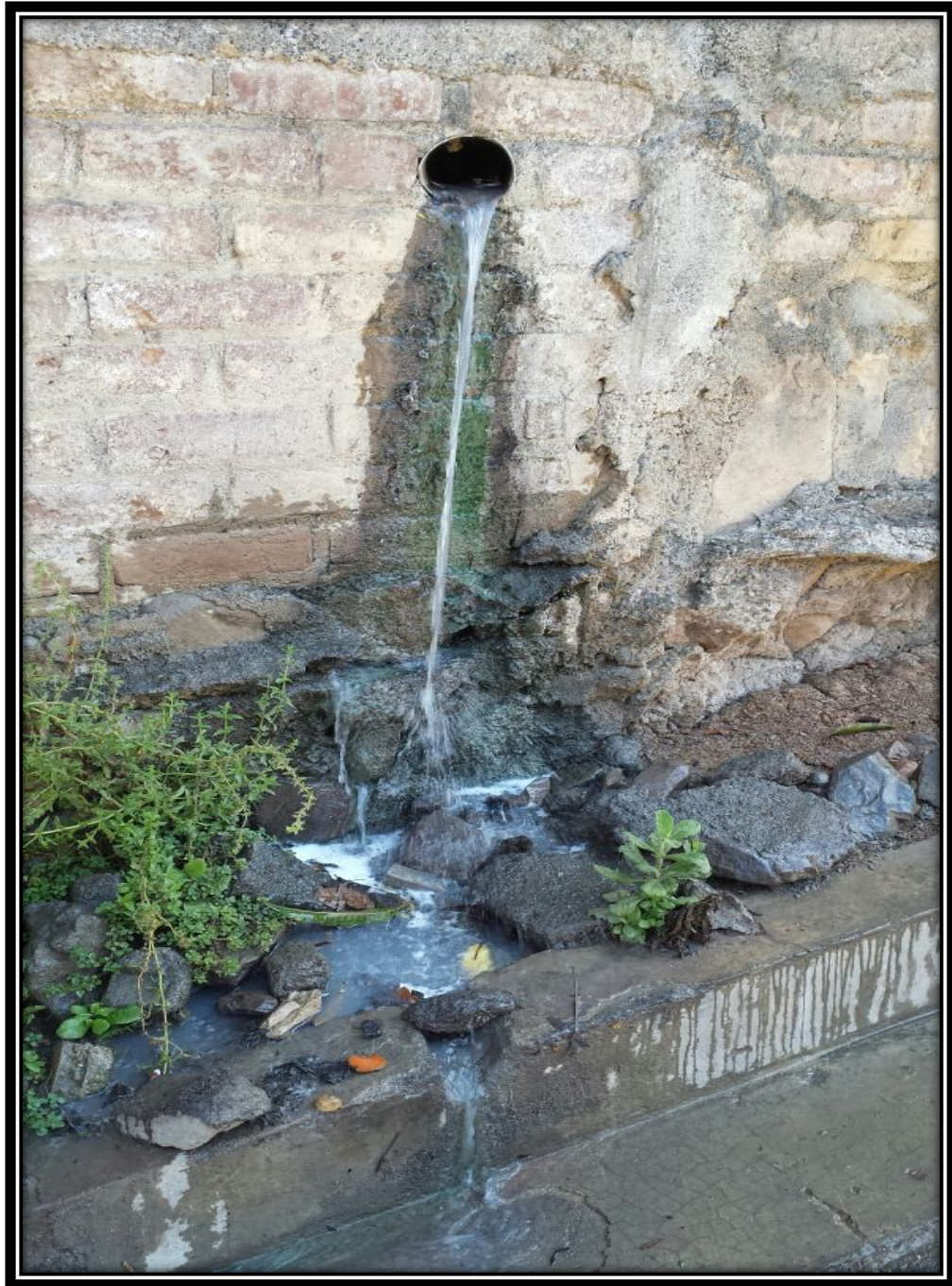
Imagen 1. Aguas grises evacuadas hacia las calles.
