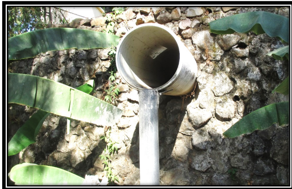
Imagen 38. Tubería de PVC con salida hacia quebrada
