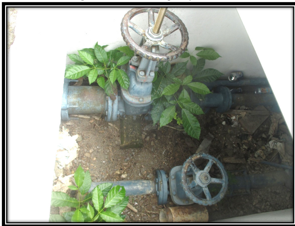
Imagen 16. Válvulas de limpieza y de cierre.
