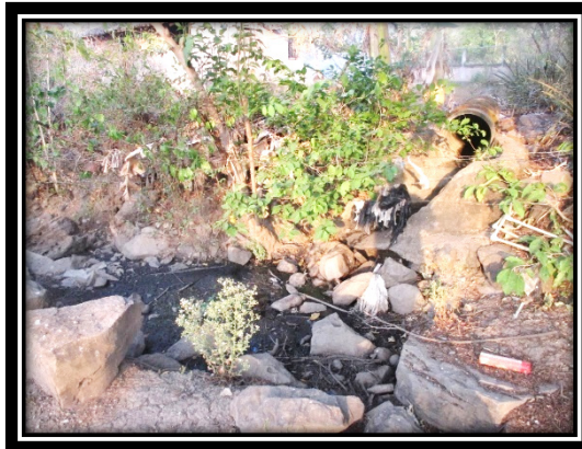
Imagen 42. Tubería de concreto con salida a terreno.
