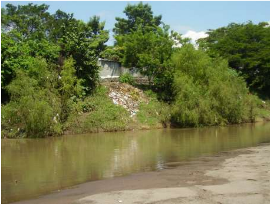
Fotografía N° 1.1: Muestra la proximidad de 3.60 m y la poca altura de 4.10 m de las casas de la Colonia Jardines del Río con respecto al Río Grande de San Miguel.
