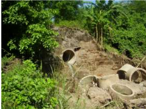
Fotografía No. 13: Muestra el talud y la socavación que se ha dado por la falta de muro de protección para la Salida de Agua Residual en la Urbanización Palo Blanco
