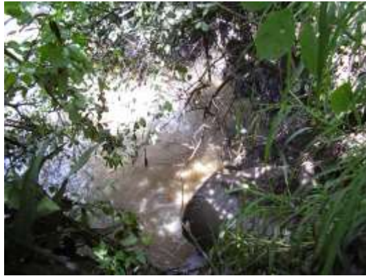
Fotografía No. 7: Muestra la descarga de agua residual al Río a la orilla de la Colonia Jardines del Río y la socavación por la falta del muro de protección
