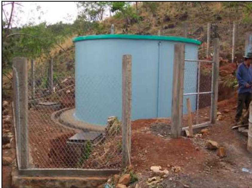
Fig. 2.18. Tanque de Almacenamiento de Agua
