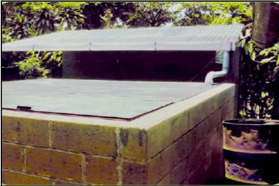
Figura 2.31 Recolección de agua en techos Domiciliar
