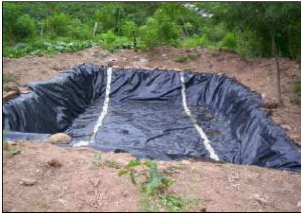
Figura 2.42 Aljibe Revestido con Polietileno
