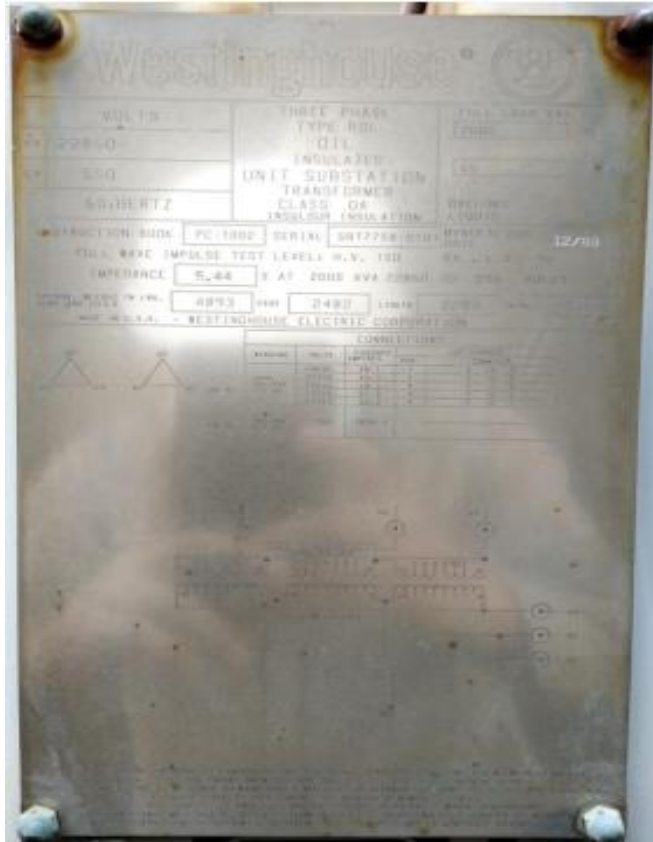
Ilustración 29 Placa con características técnicas de sujeto de prueba 2. Fuente; Cortesía GRUPO PELSA
