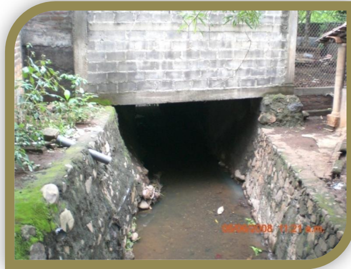
Fotografía 3.2.1.6 En la parte baja encontramos mayor impermeabilización, ya que se han construido casas sobre el cauce de la quebrada y otras en las orillas sin dejar zona de protección.
