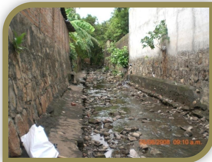
Fotografía 5.1.2.13 Parte baja, área urbanizada, en las cuales han utilizado las zonas de protección de la quebrada para establecer sus viviendas por lo cual han reducido el cauce de la quebrada.
