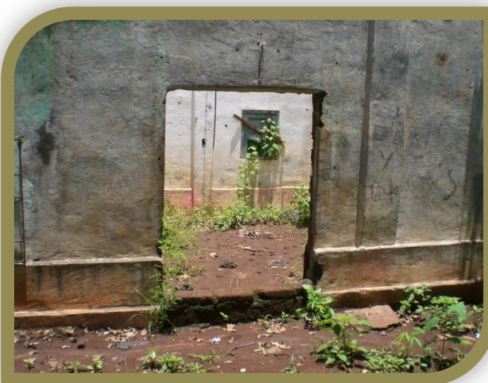
Fotografía 3.5.5 Destrucción de casas por la escorrentía durante el huracán Dean en Agosto del 2007 en el barrio San Antonio se observa la casa sin techo.
