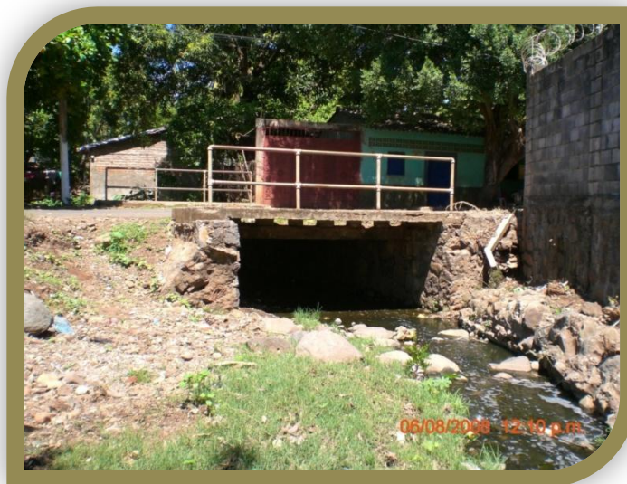
Fotografía 4.5.6 Tramo 3 puente contiguo a escuela Hugo Lindo sobre la 12 a avenida norte en el sector Villalta, puente de una sola sección.
