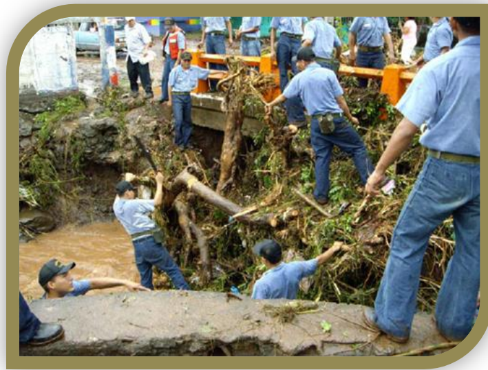
Fotografía 3.5.1 Taponamiento de las secciones de los puentes, producto de ramas, árboles talados y arrancados por la escorrentía, así como sedimentos.
