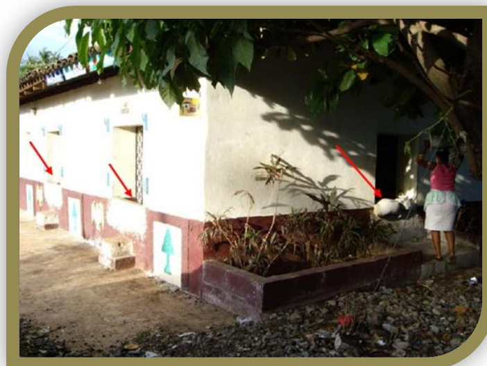
Fotografía 3.2.1.17 Aumento de altura de pretiles en casas por los desbordamientos de la quebrada después de lo ocurrido por el huracán Dean.
