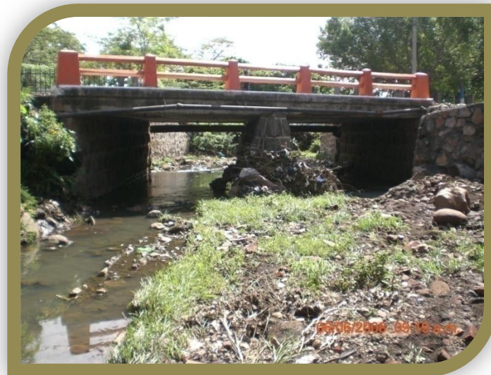
Fotografía 4.5.5 Tramo 2 Sección a analizar la cual cuenta con dos bóvedas y se observa sedimentos en las secciones del puente.
