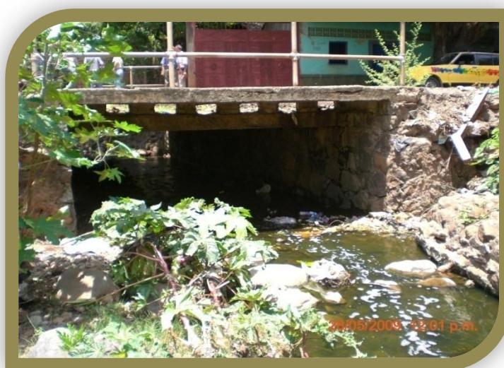
Fotografía 5.3.1.1 Basura, ramas, sólidos arrastrados por la escorrentía.
