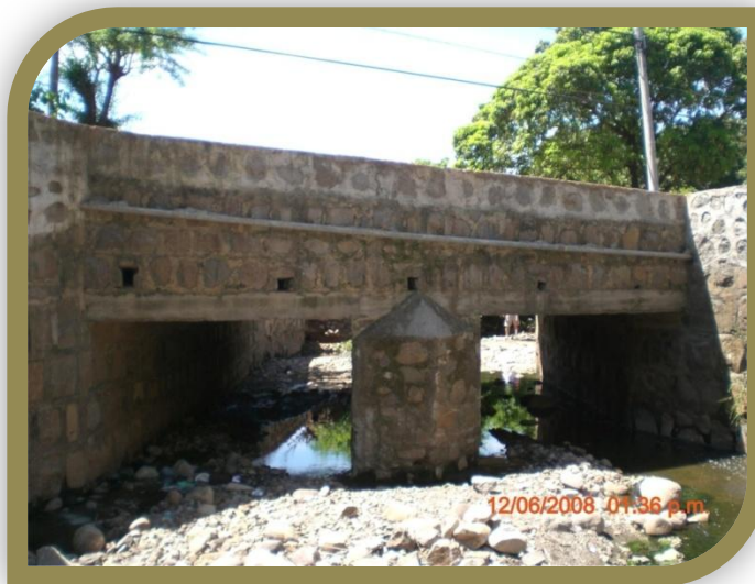
Fotografía 4.5.2 Tramo I Punto de interés para el análisis de nuestro estudio, en la parte inferior del puente se observan sedimentos arrastrados por la escorrentía.
