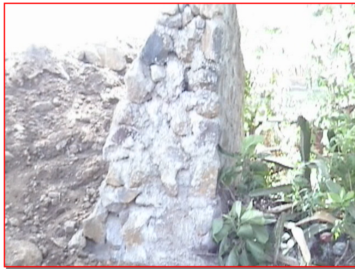
Fig. 4.101 cabezal de descarga de aguas lluvias.
