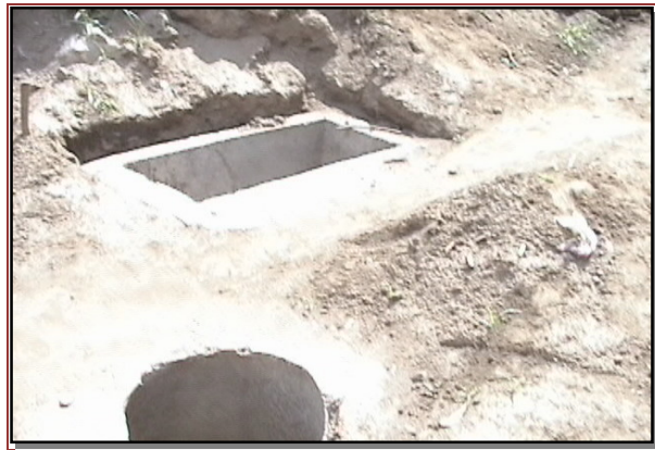
Fig.3.44 Pozo con su respectiva caja colector.
