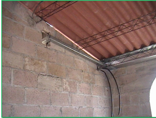
Fig. 4.127 viviendas con su respectiva instalación eléctrica.
