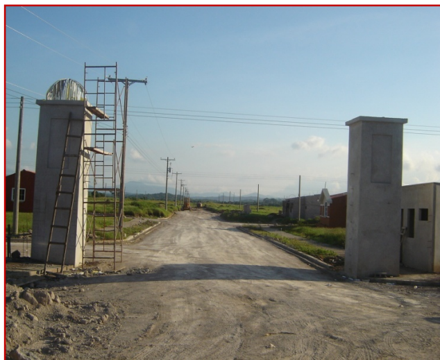
Fig. 3.56 Tendido Eléctrico según lo estable la EEO.
