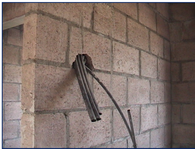
Fig. 3.80 Ductos para toma corriente
