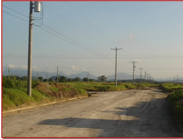
Fig.3.58 Tendido eléctrico en la urbanización.
