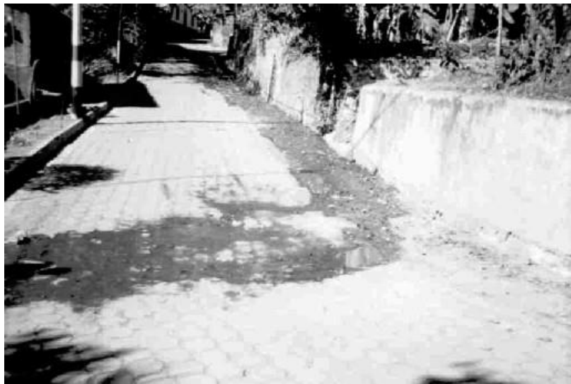
Fotografía 2.4: En la imagen se observa, como las aguas al fluir por las cunetas, atraviesan la sección transversal de algunas calles, generando mal aspecto en el lugar.
