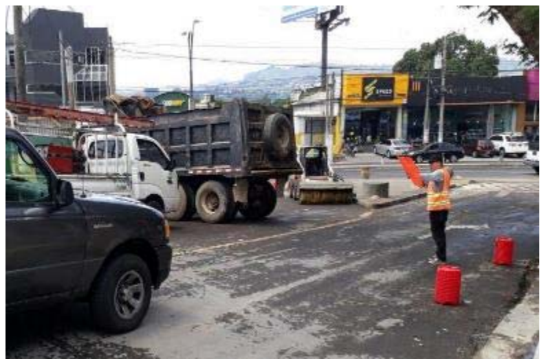
Gestores de trafico
