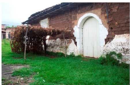
Acceso lateral Norte, observese el desprendimiento del repello y las fisuras causadas por los sismos del año 2001.
