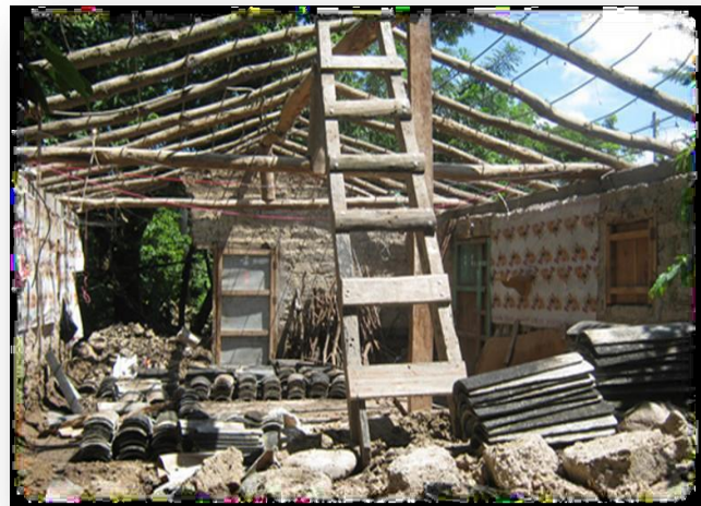
Fotografía 1.4 Vivienda afectada en La Colonia Los Romeros Fuente: Grupo de Investigación
