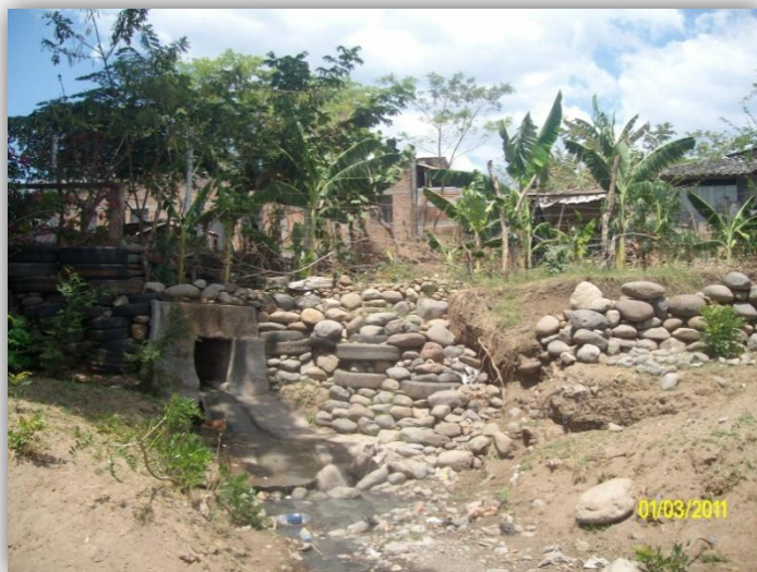
Fotografía 5.6: Aguas servidas Fuente: Grupo de Investigación
