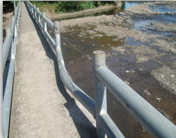
Fotografía 1.2 Pasarela dañada en el Barrió El Calvario Fuente: Grupo de Investigación
