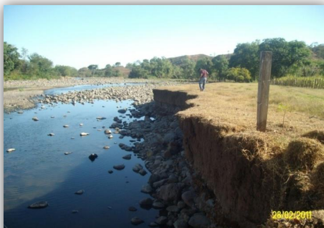
Fotografía 4.10 Deslizamiento de talud. Fuente: Grupo de Investigación
