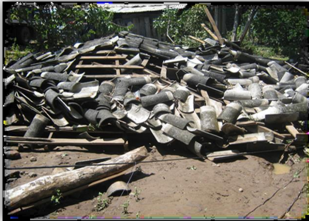
Fotografía 1.1 Vivienda completamente dañada en La Colonia La Prado Fuente: Grupo de Investigación
