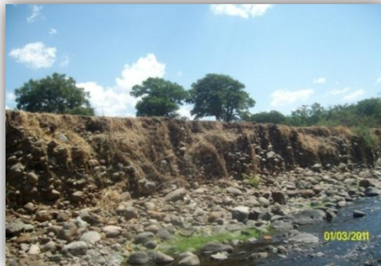
Fotografía 4.5 Socavación del talud Fuente: Grupo de Investigación
