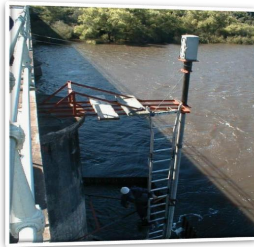
FIGURA II.3.5.2: INSTALACIÓN DE LIMNÍGRAFO MECÁNICO SOBRE UN PUENTE.
