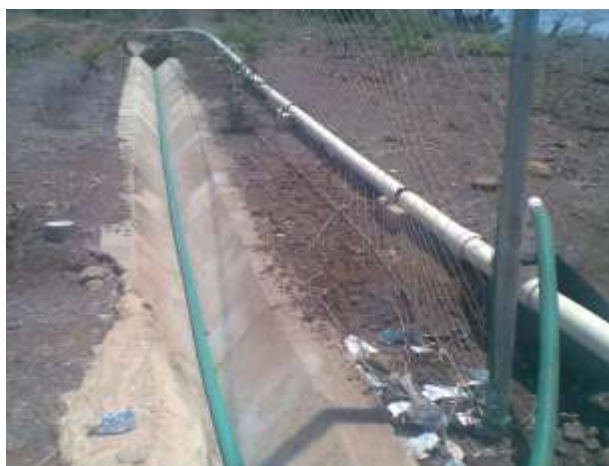
Fotografía 4.22 Sistema para recirculación de lixiviados.
