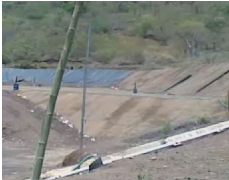
Fotografía 4.15 Canaletas para drenar las aguas lluvias.
