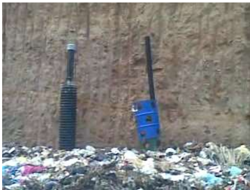
Fotografía 4.8 Detalle de bajado de lixiviados de terraza a terraza.
