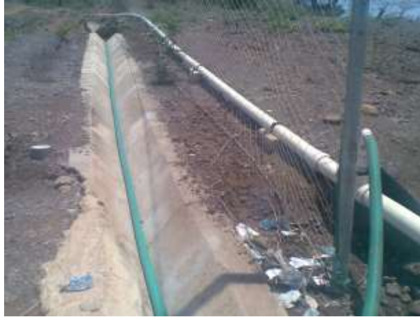
Fotografía 5.6 Sistema para recirculación de lixiviados.
