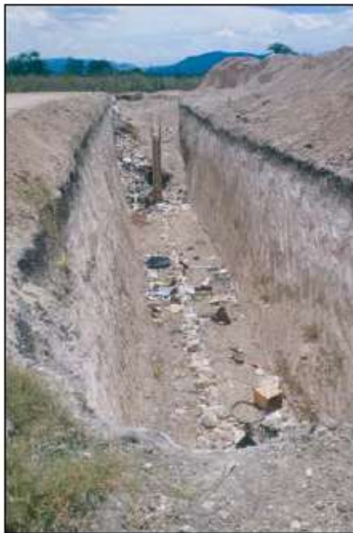
Fotografía 2.7 Trinchera con drenaje y Chimenea para biogas.
