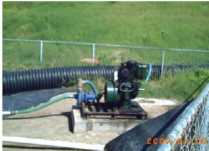
Fotografía 4.41 Bomba para la recirculación de lixiviados.
