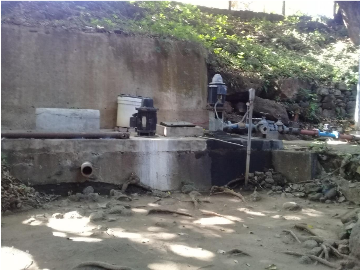
Figura. Equipo de Inyección de Cloro al Sistema de Bombeo
