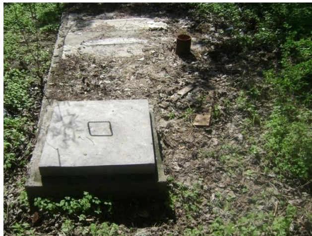
Figura 3.5 Fosa de captación del edificio de la biblioteca.
