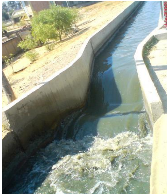
Figura2.4 Canaleta aforadora de Parshsall
