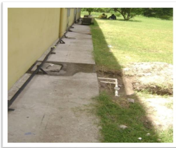
Fig. 3.31 Medidor de agua para el Edificio de La Biblioteca.
