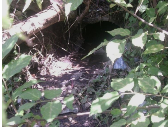
Fig. 3.19 Punto de descarga de aguas provenientes del edificio de la biblioteca,
