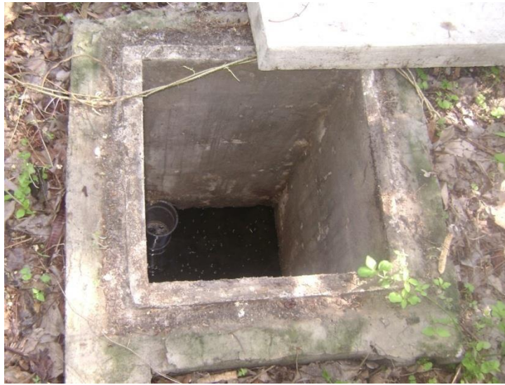
Figura 3.6 Caja de inspección del filtro biológico
