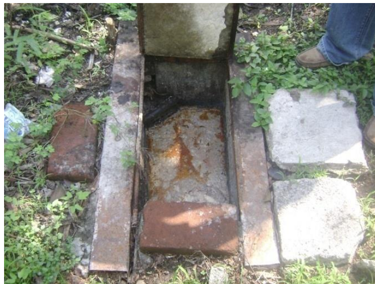
Fig. 3.10 Separador de grasa y aceite en mal estado.
