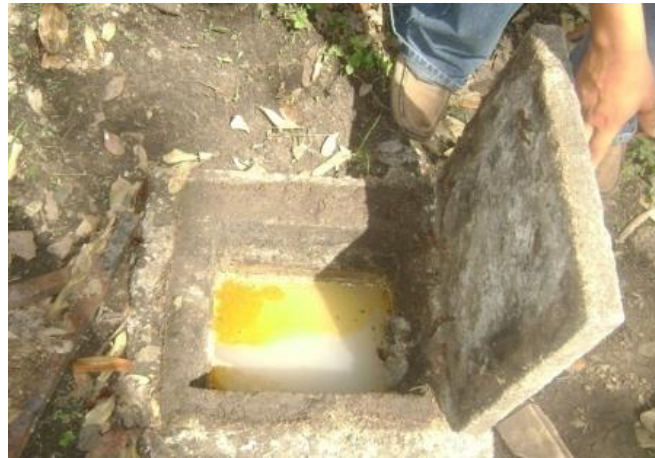
Fig. 3.11 Caja desengrasante de Cafetín ubicado al norte del auditorio.
