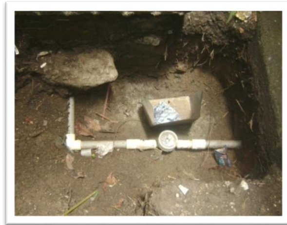
Fig. 3.24 Medidor Para Baños Ubicados Al Costado Sur del Auditorio General.
