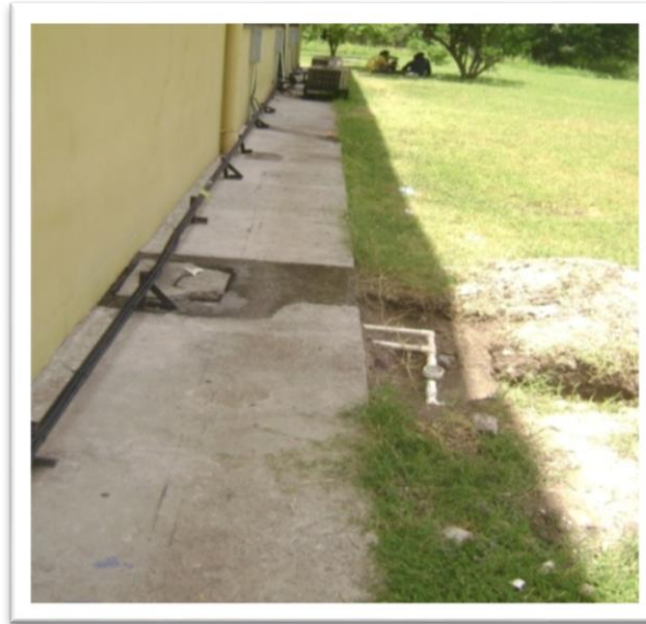
Fig. 3.28 Medidor Para Edificio de La Biblioteca.
