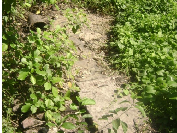
Fig. 3.21 Punto de descarga de aguas residuales proveniente de los cafetines.
