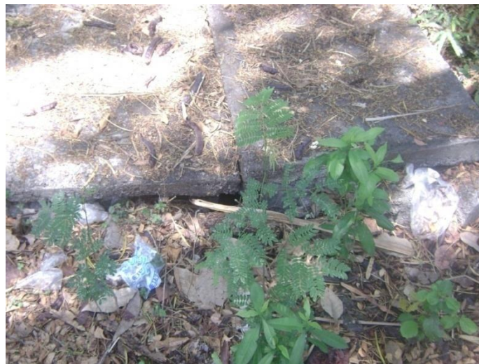
Fig. 3.15 Grietas en fosa de captación del Laboratorio de Biología.
