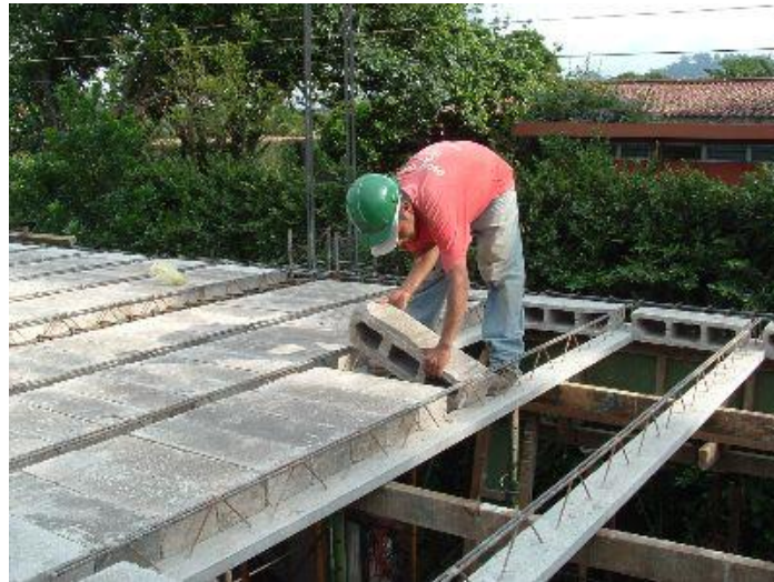
La Fig. 19 Demuestra la colocación de losetas para el colado de la losa.
