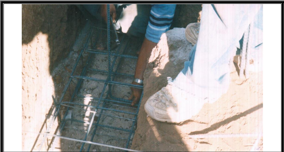
FIGURA 5 - 21: Colocación del bastón sobre las marcas para evitar problemas de modulación con la pared
