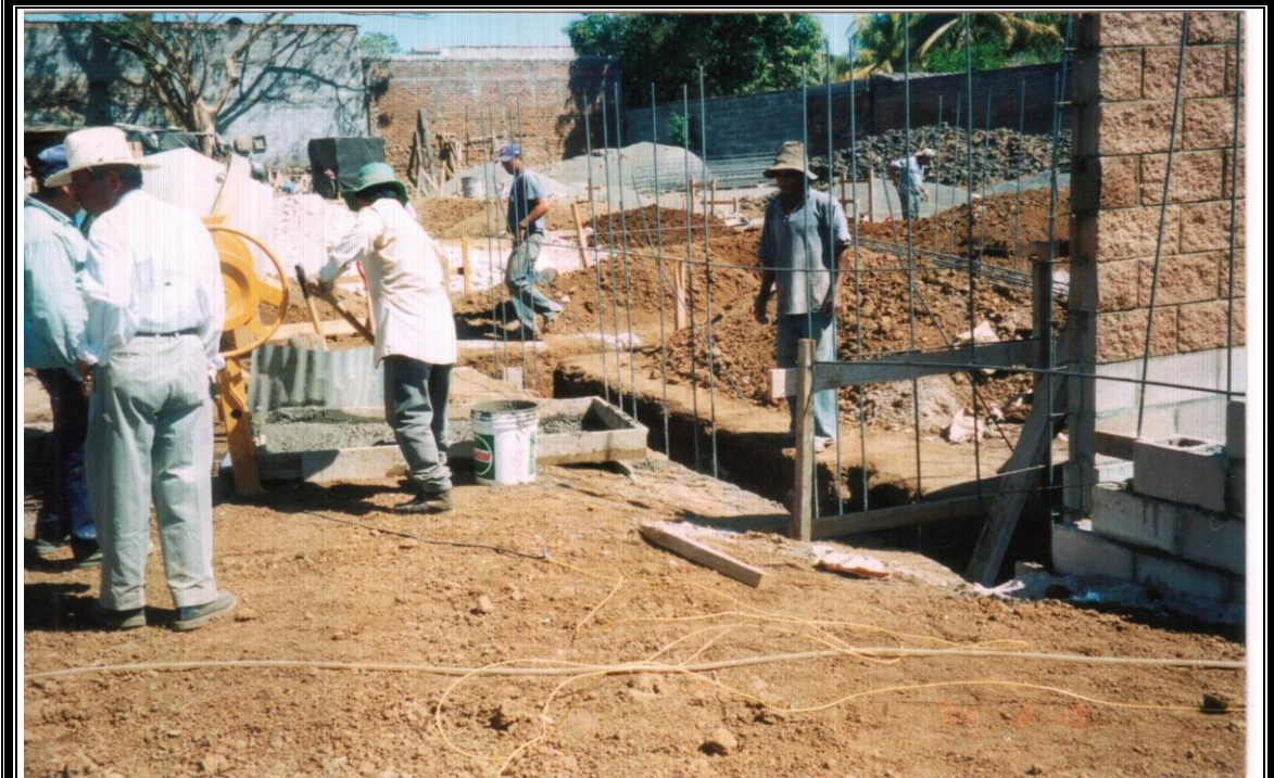
FIGURA 5 - 30: Apaleado del concreto de la batea a la carretilla o cubeta para su transporte
