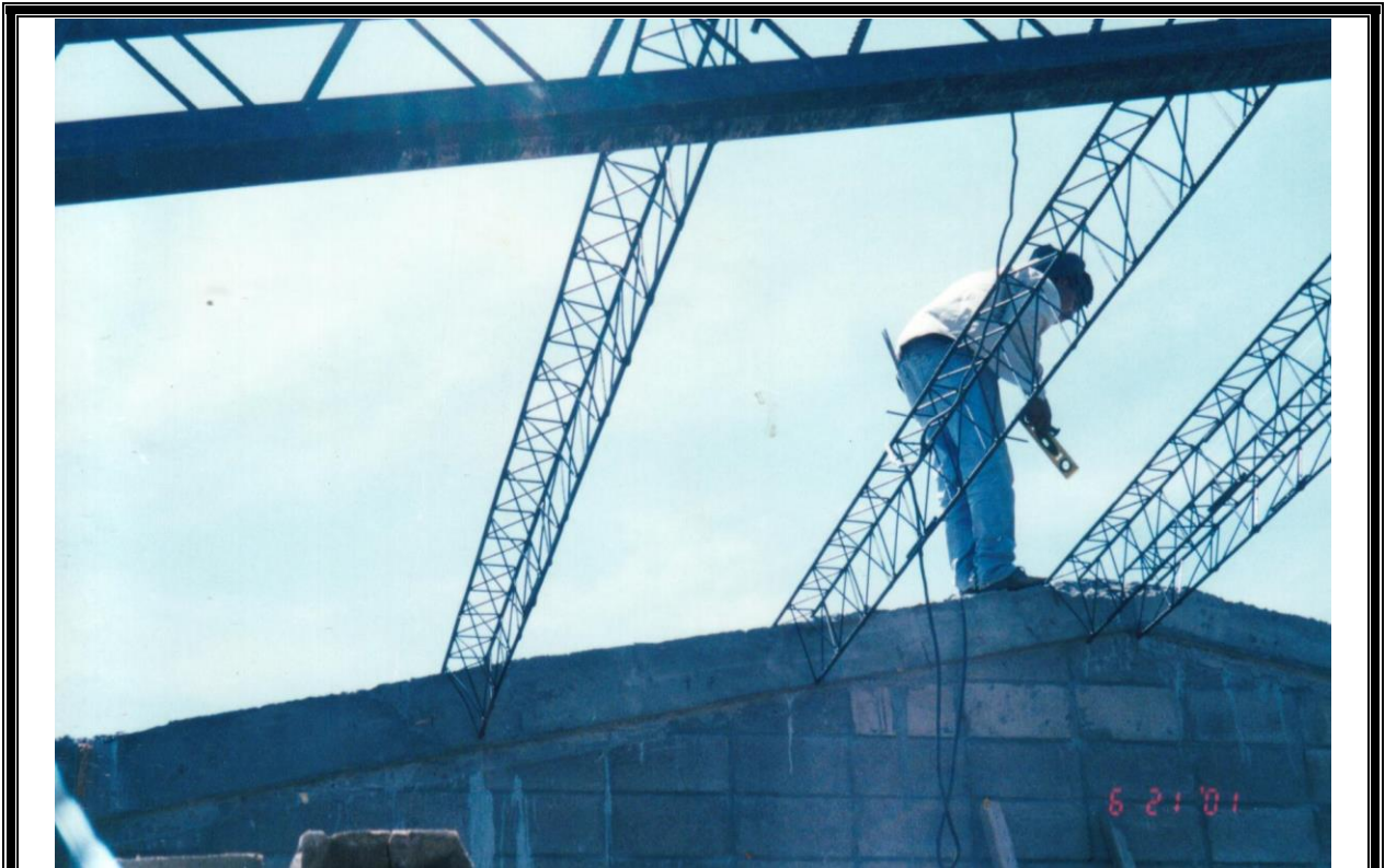
figura 6-17: Obrero soldando en la solera todos los polines de arriba hacia abajo de la cumbrera
