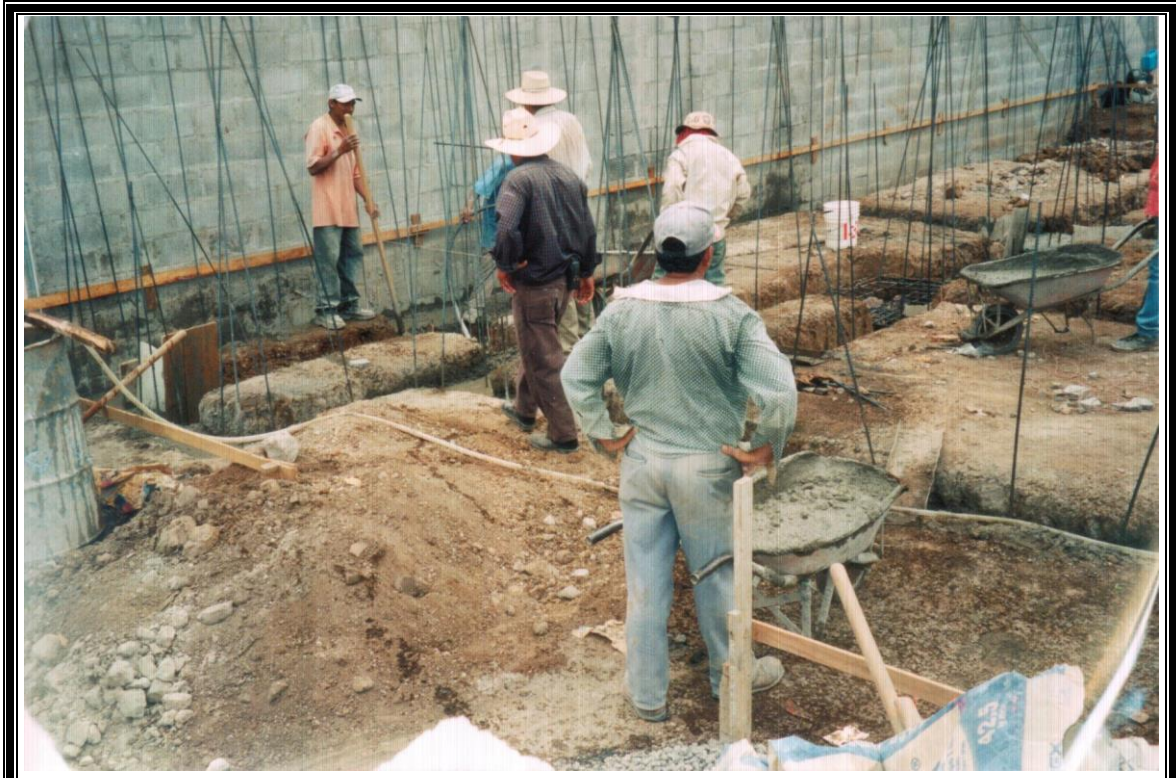
FIGURA 5 - 26: Colocación de puentes para facilitar el paso de las carretillas a través de excavaciones no coladas
