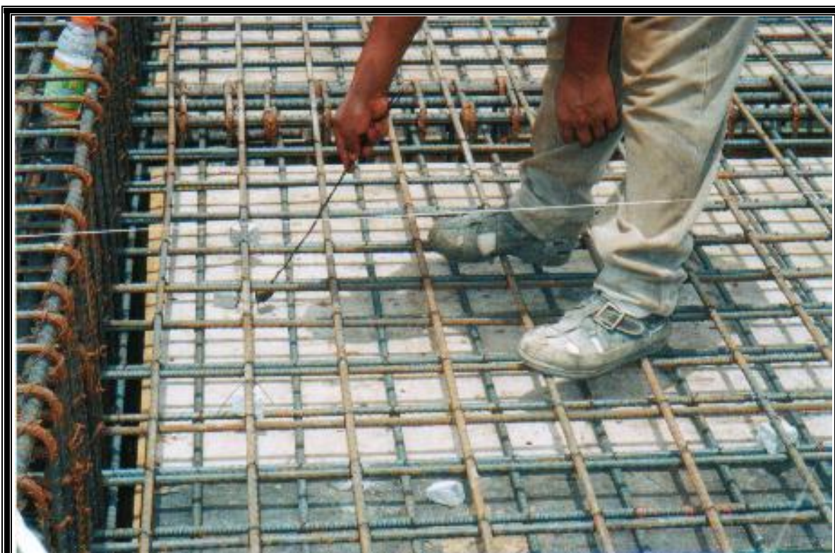
Figura 4-94: Auxiliar utilizando un imán para la limpiar la estructura de alambre de amarre y clavos
