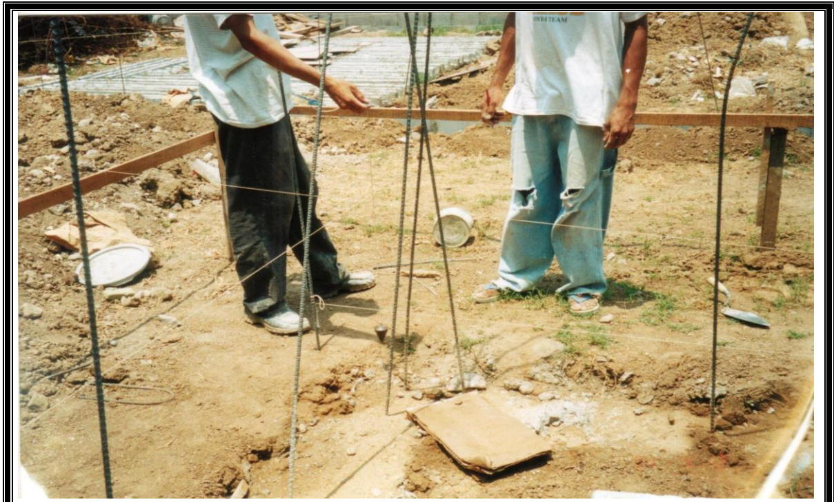
FIGURA 5 - 36: Bajado de puntos con la plomada para definir la línea del rostro de la pared
