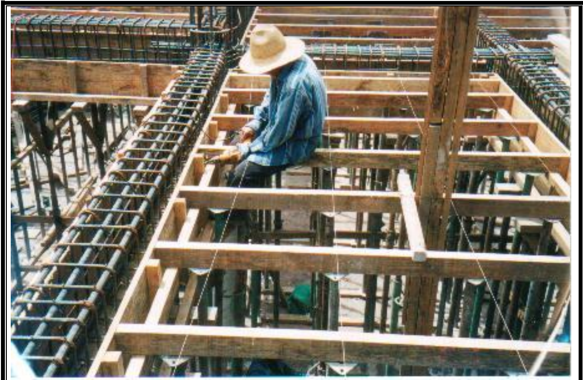
Figura 4-75: Pitas que determinan la altura, el nivel y plomo de los burros que sostendrán la losa densa
