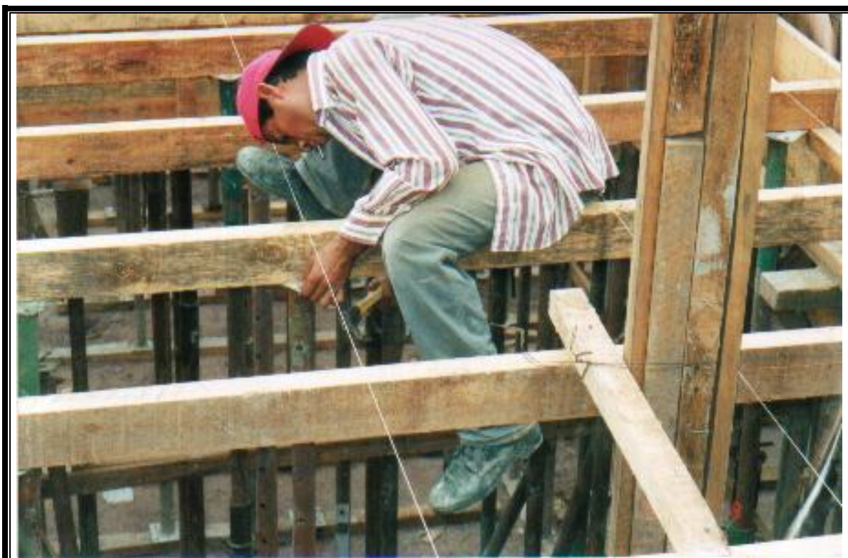
Figura 4-81: Clavado de pilotes al burro de la losa en la parte superior
