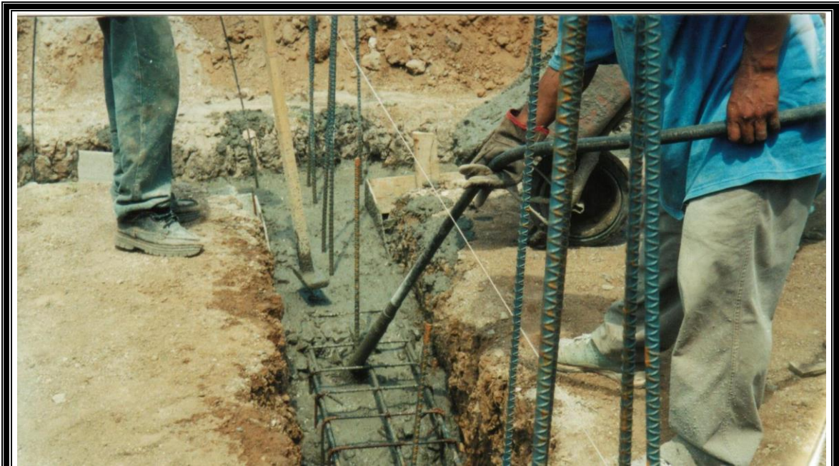
FIGURA 5 - 27: Tendido de pitas para controlar el nivel del colado de la solera
