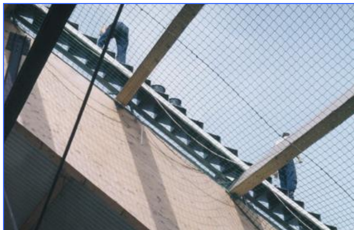
Fig. 95 Redes de protección
