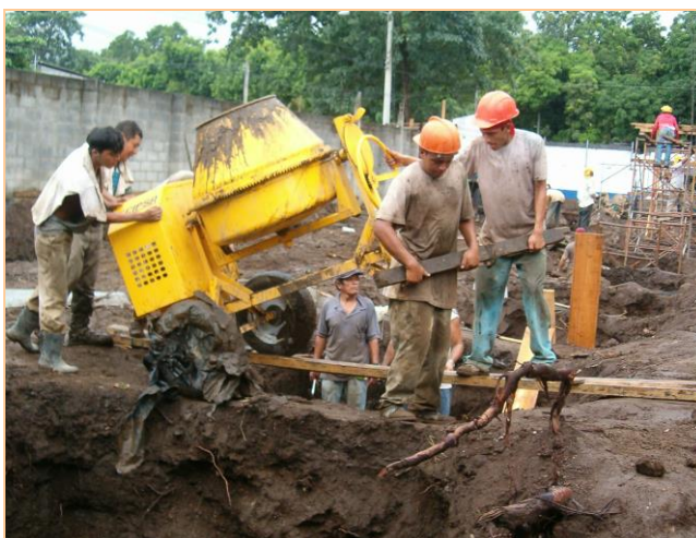
Fig. 114 Desplazamiento de carga cerca de una excavación
