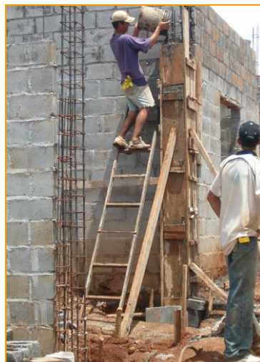
Fig. 76 Uso incorrecto de las escaleras
