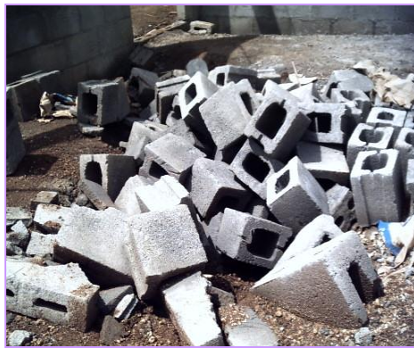
Fig. 2 Mal almacenamiento de bloques
