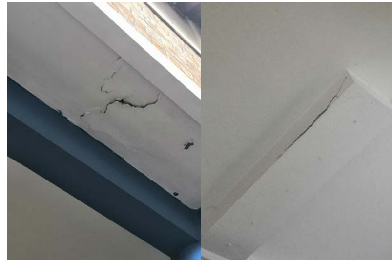
Imagen 9. Fallas estructurales identificadas en vigas y losa.
