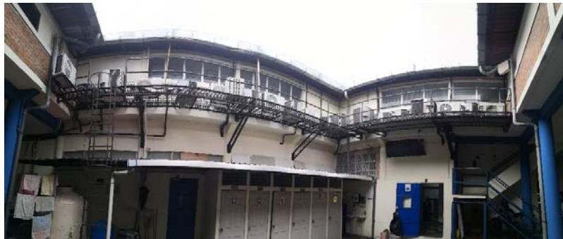
Imagen 6. Condensadores de aires acondicionados saturando el espacio de patio interno del inmueble y generando contaminación auditiva en el sector.
