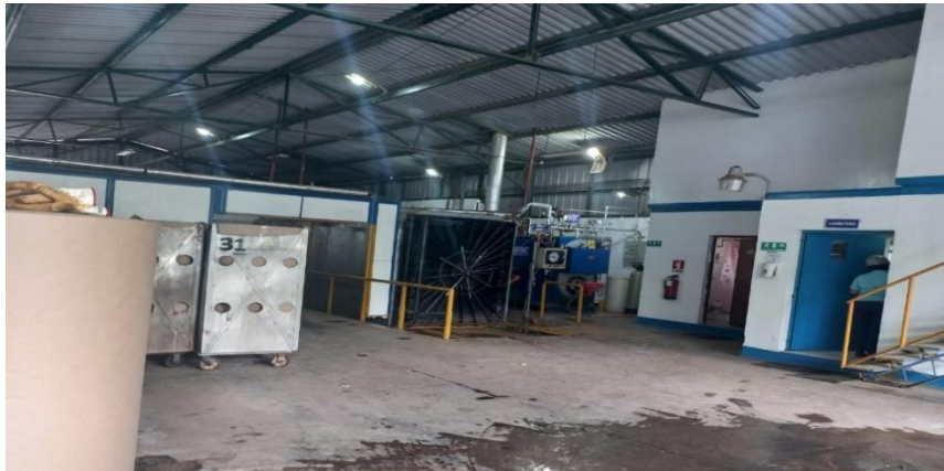
Figura N°47. Vista general del Área de Tratamiento de Desechos Peligrosos del Relleno Sanitario MIDES
