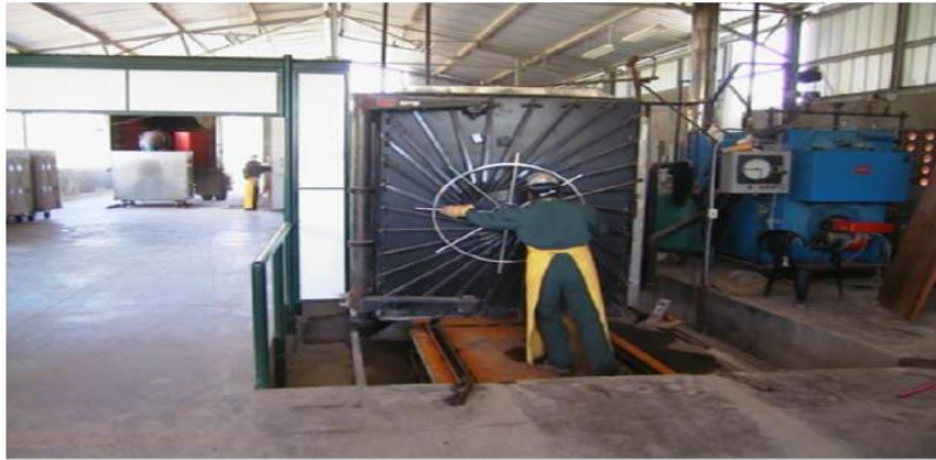
Figura N°46. Autoclave utilizando para la esterilización de los desechos bioinfecciosos
