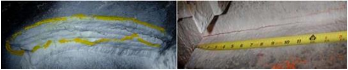
Fig. A.5. Grieta visualizada mediante partículas negras húmedas.
