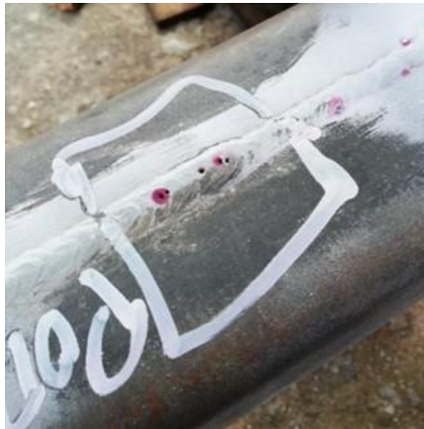
Fig. 1.6. Porosidades en soldadura [5].
