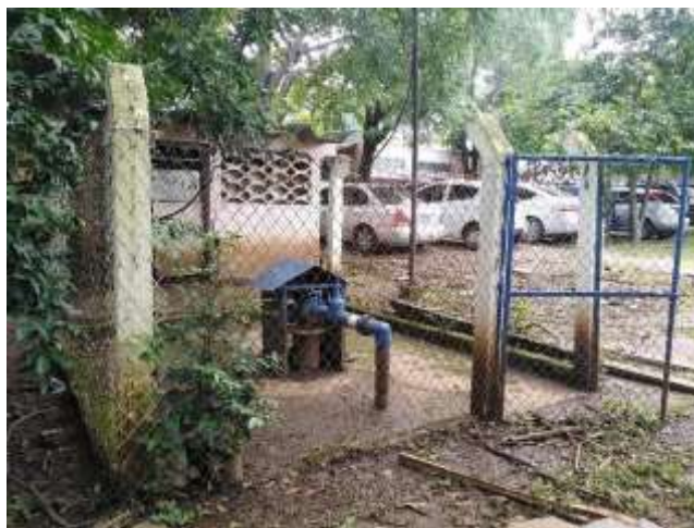
Ilustración 22: Pozo de agua potable
