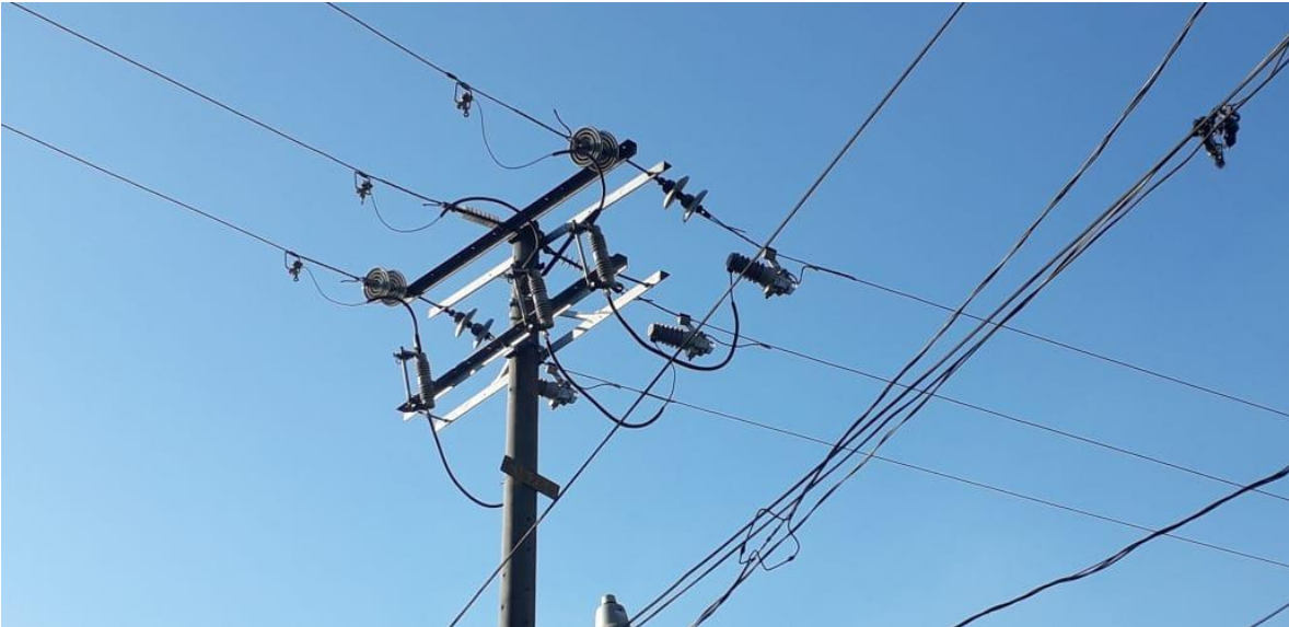
Figura 2.1: Instalación de Fusesaver en Mejicanos, San Salvador
