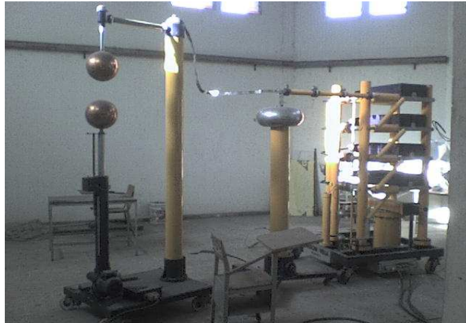
Figura 3.1: Generador de impulsos tipo rayo de la EIE.
