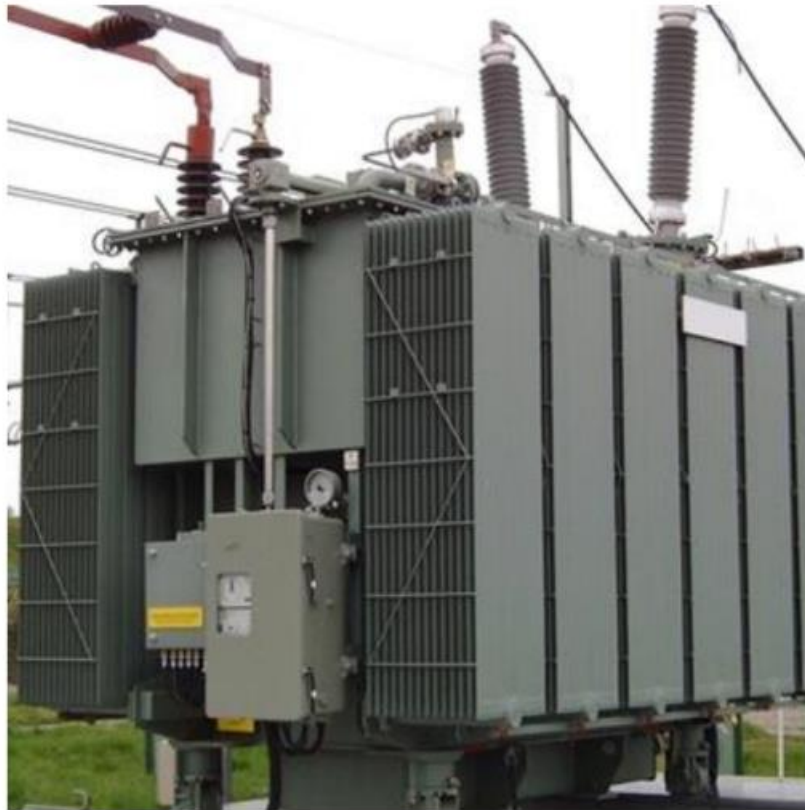
Figura 1 Transformador de Potencia (Juárez et al, 2018)
