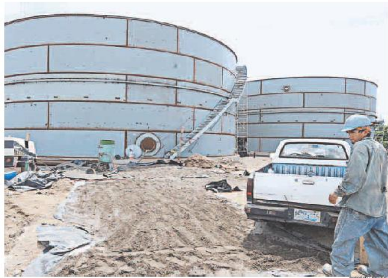
TANQUES de almacenamiento, que a esta fecha ya están terminados. Sólo faltan las tuberías para bajar los combustibles desde los barcos.
