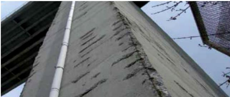
Figura 2.38: Daños por carbonatación en estructuras de concreto.
