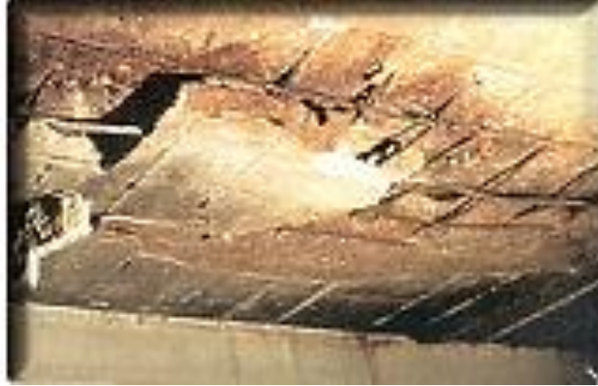
Figura 2.26. Daño del concreto por exposición a altas temperaturas.
