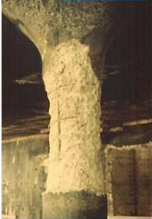
Figura 2.28: Daño en estructuras de concreto causado por incendios.
