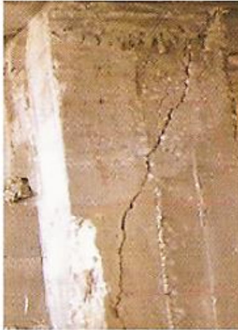
Figura 2.29: Daño en estructuras de concreto causado por sobrecargas.
