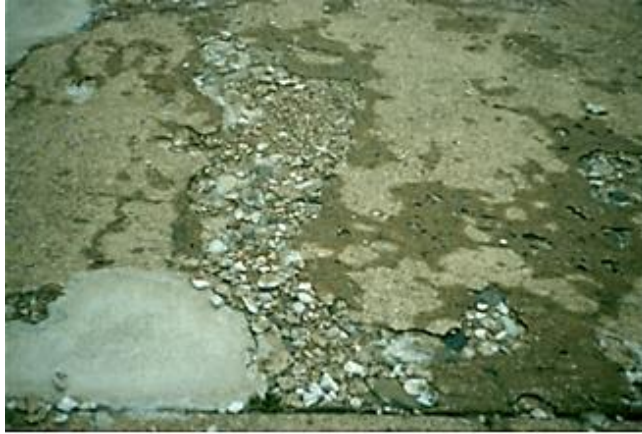
Figura 2.27: Daño en estructuras de concreto debido al congelamiento y deshielo.
