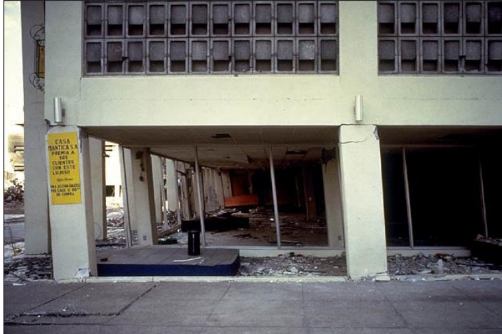
Figura 2.31: Daño en estructuras de concreto causado por cargas cíclicas.
