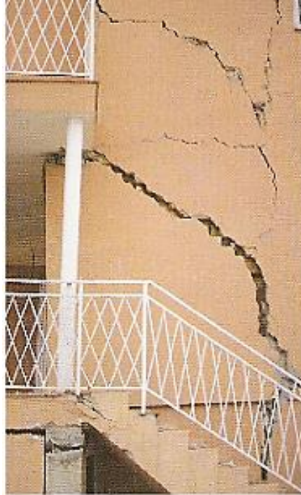
Figura 2.30: Daño en estructuras de concreto causado por asentamiento.
