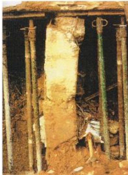
Figura 2.25. Daño de un pilar por impacto.
