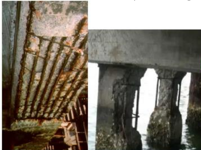
Figura 2.33: Daño en estructuras de concreto causado por la acidez de agentes agresivos.
