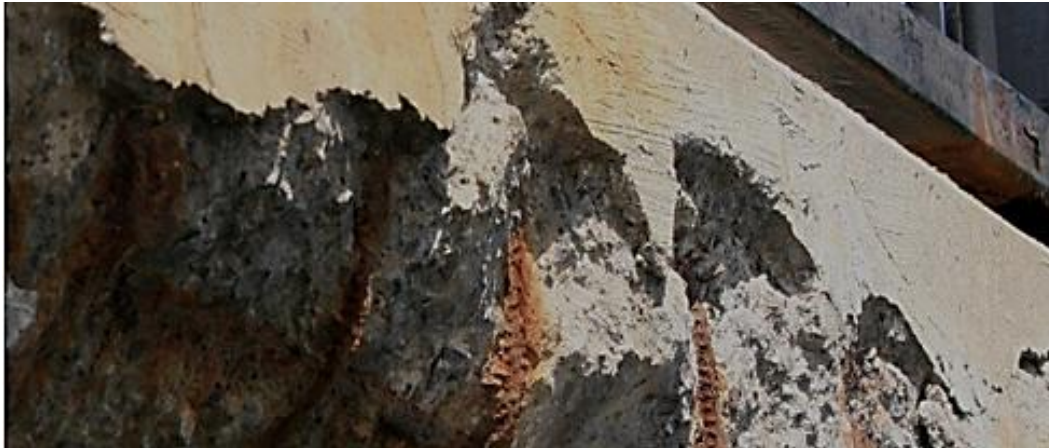
Figura 2.36: Daño en estructuras de concreto causado por hongos.
