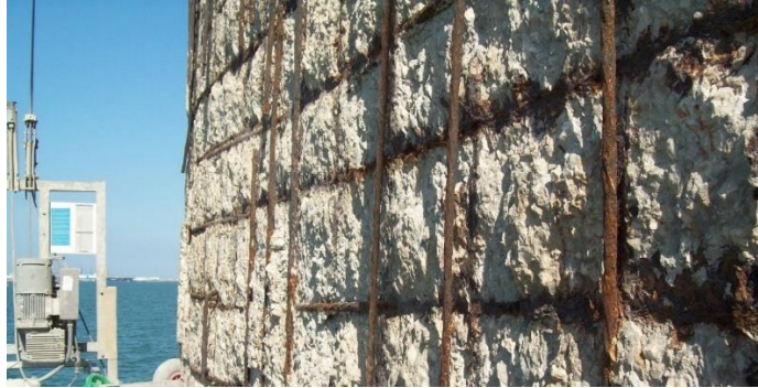
Figura 2.24. Edificio de concreto dañado por las mareas en la playa.
