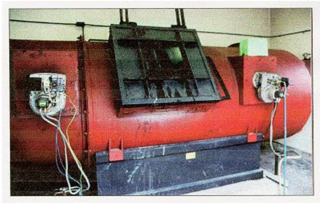
Figura N° 16 Incinerador de dos cámaras, horizontal y cilíndrico
