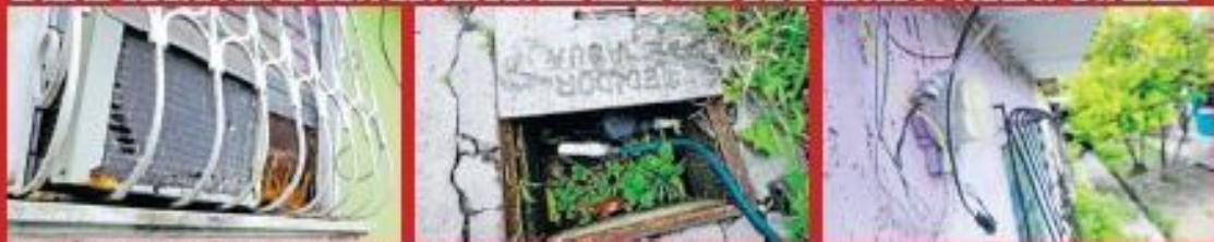
Desde el operativo Casa Segura, fueron encontradas conexiones ilegales de energía y de agua potable. Unas 120 viviendas fueron intervenidas por policías militares. FOTO EDH /
