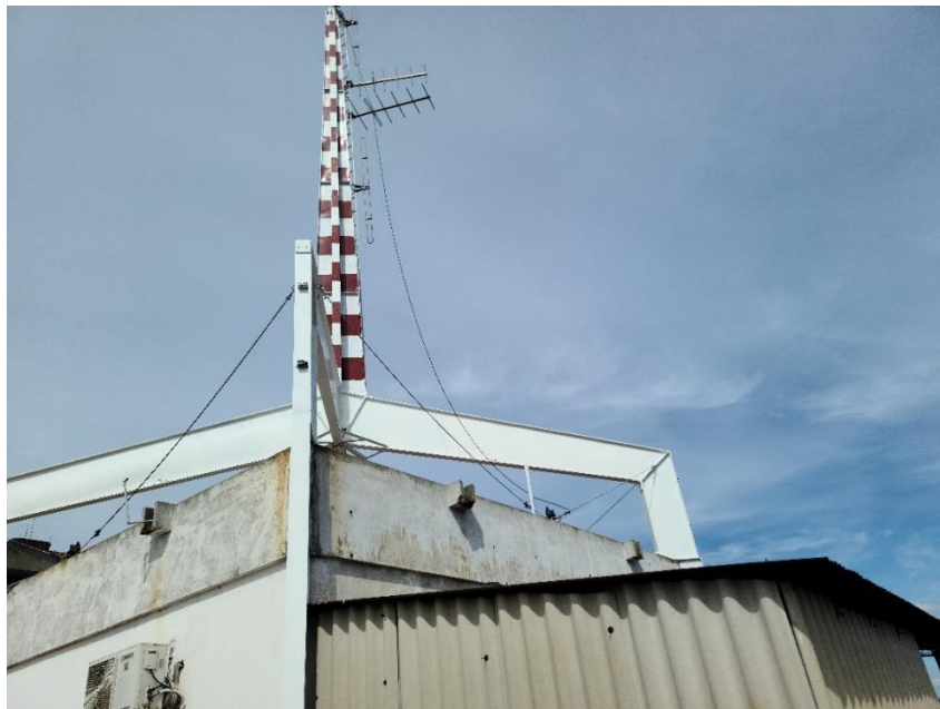
Figura 4.54 Antena necesaria de desmontar en Toree PGR San Salvador, Fuente Propia.
