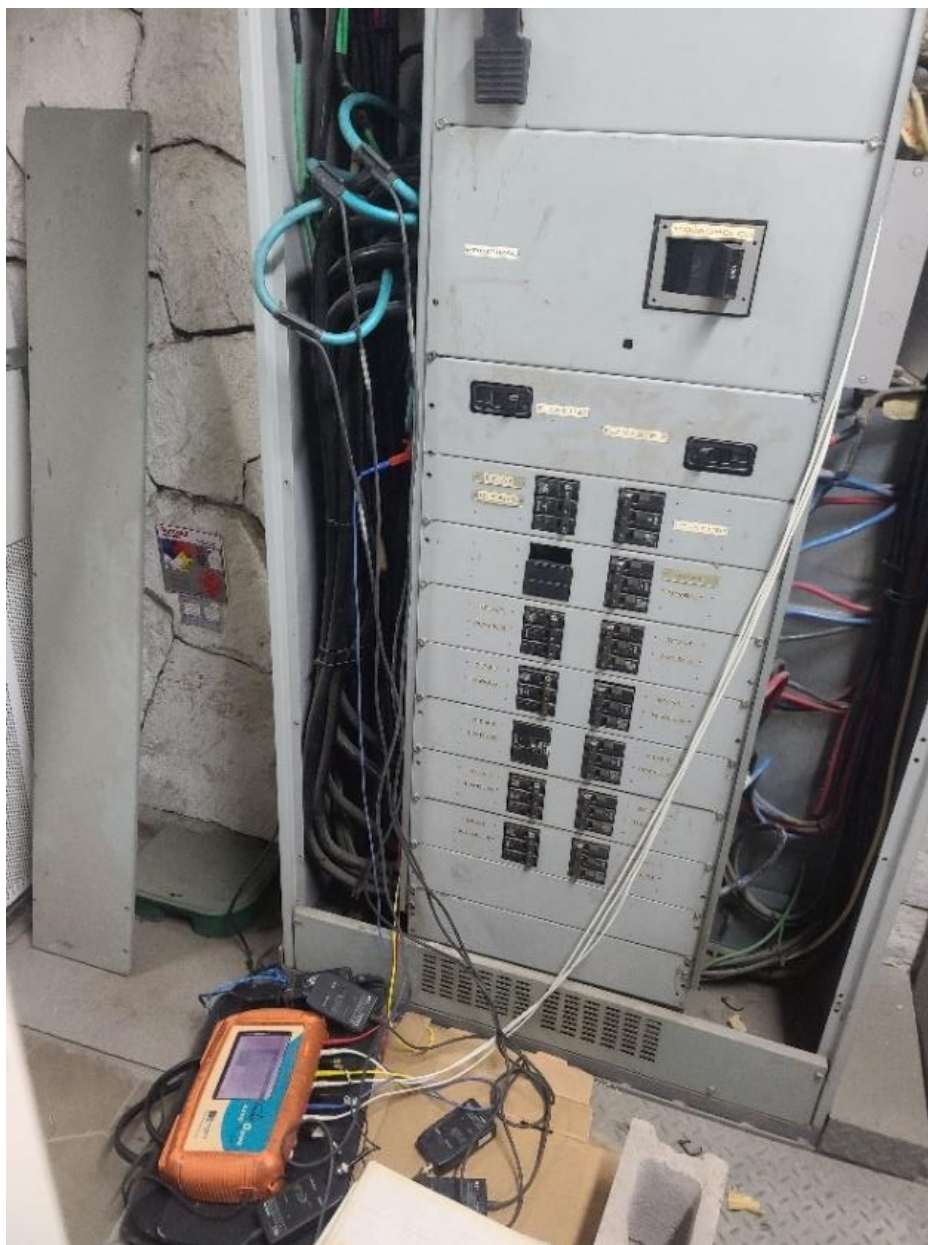
Figura 1.9 Instalación completa de equipo Dranetz 4400
