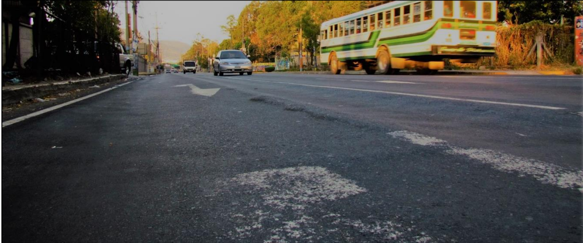
Ilustración 3. Deformación permanente o "rutting" severa (Fuente: material propio)
