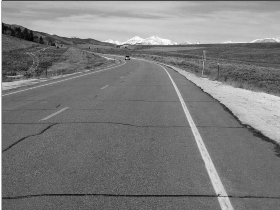
Figura 12. Grietas por baja temperatura en pavimento asfáltico, con poco tiempo de servicio.
