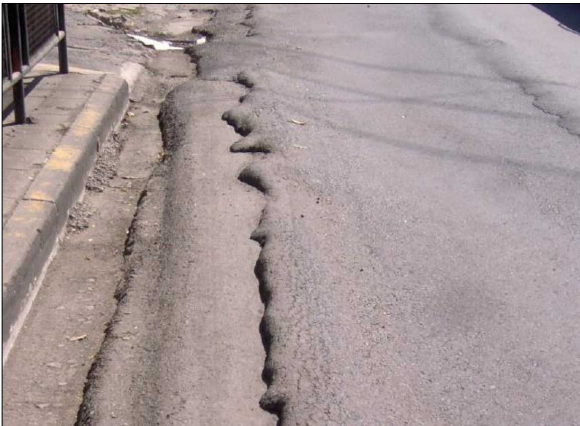
Ilustración 2. Ejemplo de capa de rodamiento asfáltica con falla por acanalamiento o "rutting"
