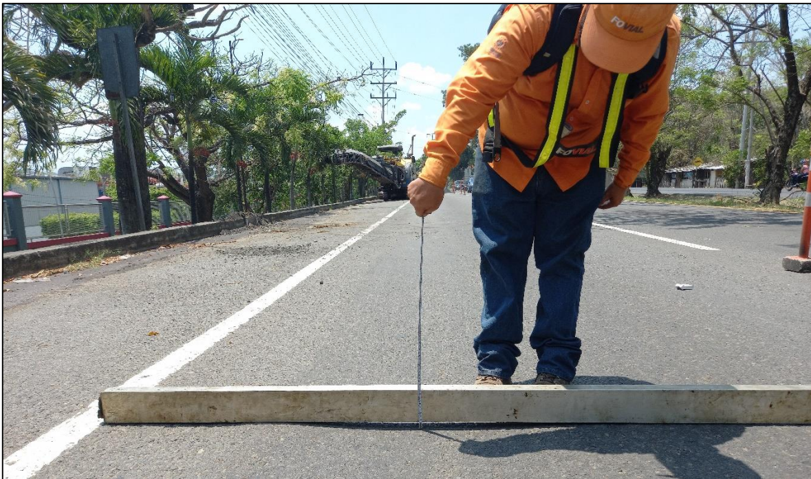
Ilustración 1. En las imágenes se pueden apreciar las deformaciones permanentes o “rutting” que se han generado en un pavimento asfáltico en la carretera Panamericana entre Santa Ana y San Salvador. (Fuente: Material fotográfico propio)
