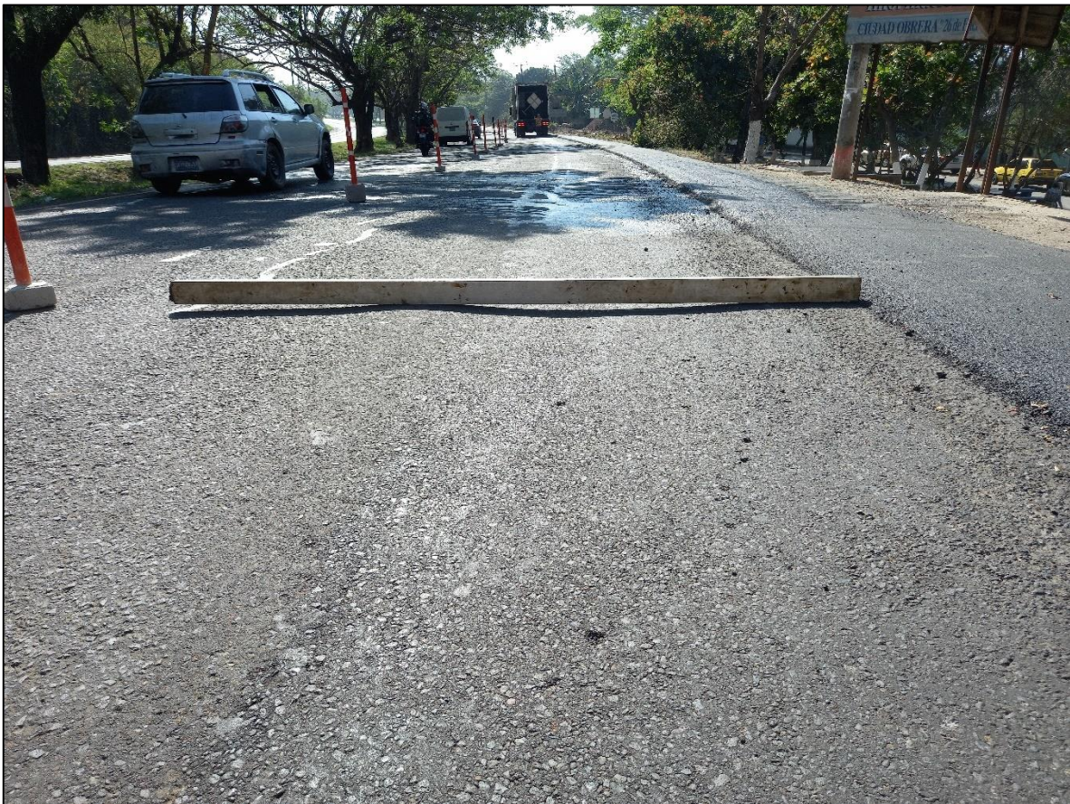
Figura 9. "Rutting" Falla por deformación permanente en un pavimento asfáltico (Fuente: material fotográfico propio)
