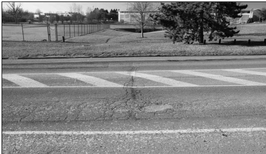
Figura 13. Grietas por baja temperatura, con largo tiempo en servicio
