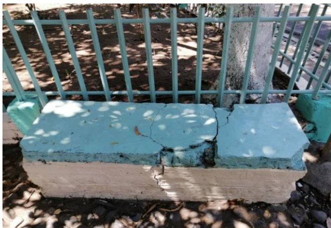
Figura 23: mobiliario urbano, banca de concreto (mal estado)
