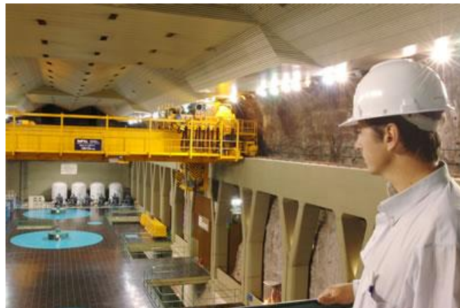
Figura 5. Central hidráulica de bombeo, “Río Grande” ubicada en Argentina[2].
