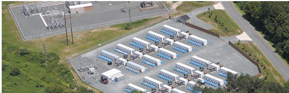
Figura 11. Planta de almacenamiento de energía de Stephentown de Beacon Power [12].
