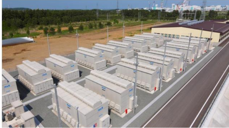
Figura 22. Sistema de almacenamiento de energía con baterías sulfuro de sodio, Japón[21].
