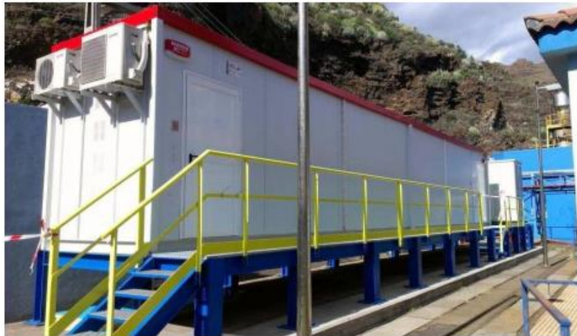
Figura 18. Sistema de almacenamiento de energía mediante supercondensadores, La Palma, España[18].
