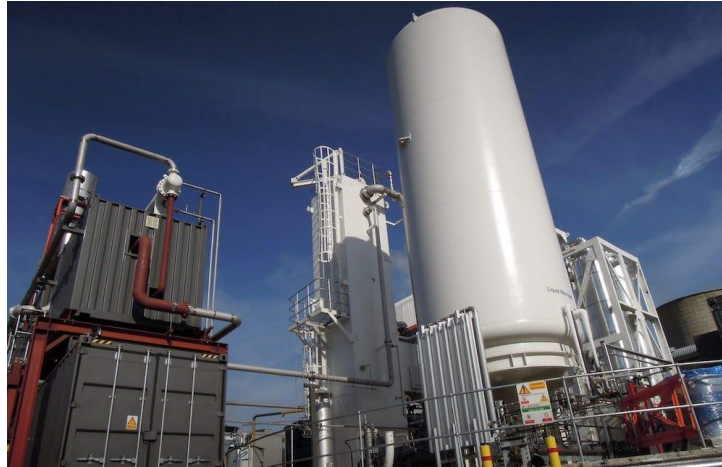
Figura 9. Sistema de almacenamiento de energía LAES ubicado en Reino Unido[9].
