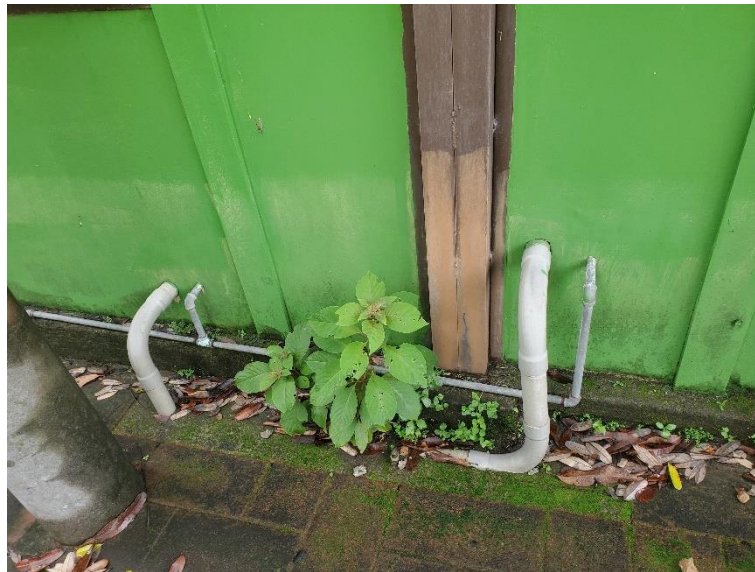
Figura N°23. Tuberías de agua potable y aguas negras.
