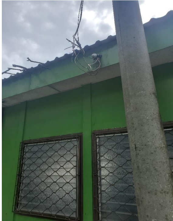
Figura N°24. Conexión de luz eléctrica.
