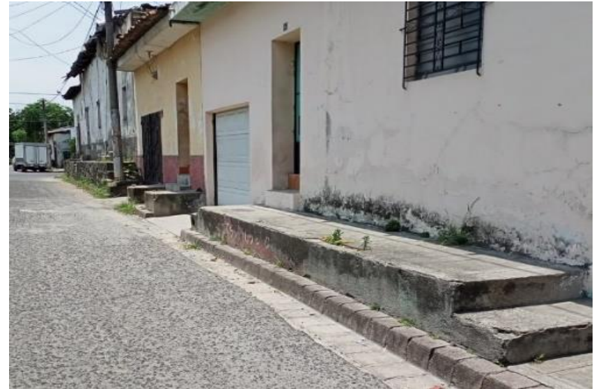
Figura 63. Desniveles en aceras
