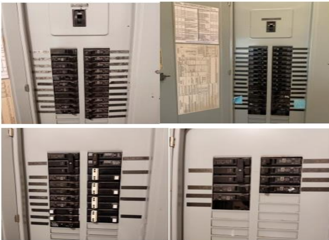
Figura J.21 Subtableros Segundo Nivel edificio de Medicina
