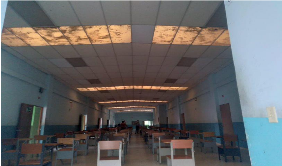
Figura J.17 Vista desde el interior del área de techos 1 edificio de medicina
