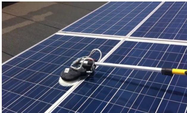
Figura 1.23 Limpieza del panel solar fotovoltaico
