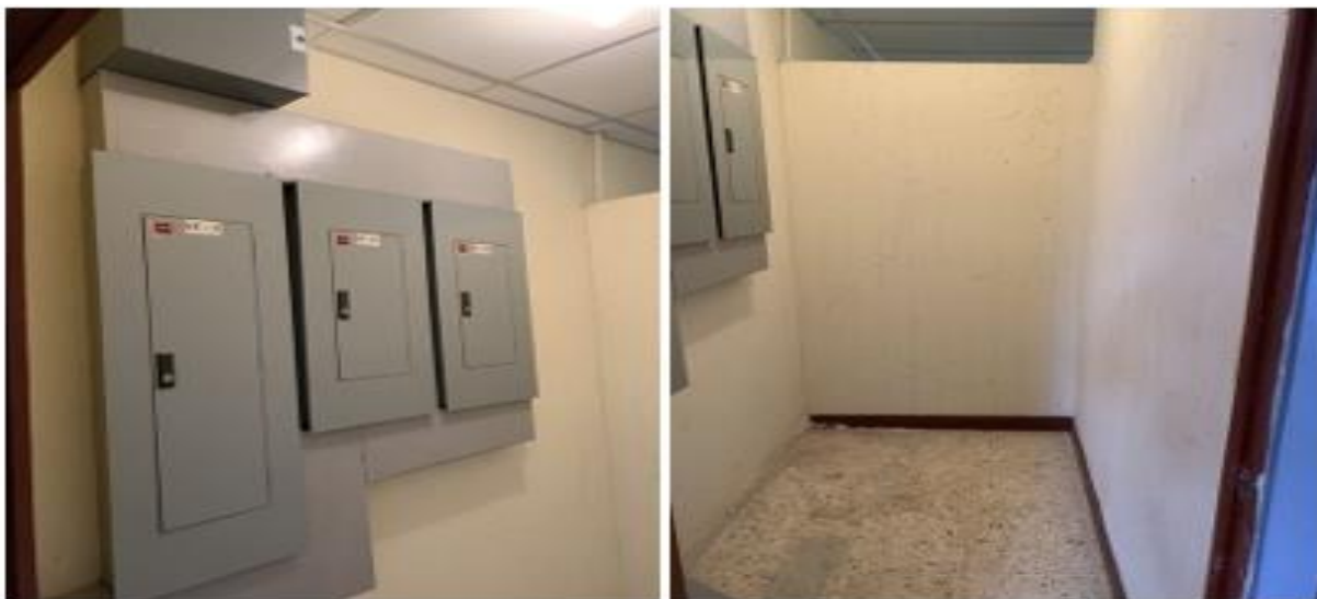
Figura J.10 Cuarto de Inversores edificio de usos múltiples
