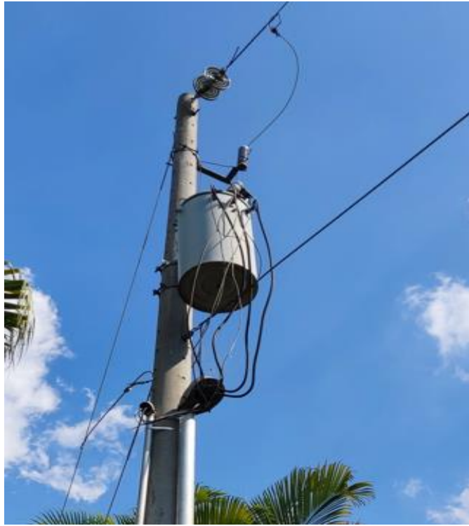
Figura J.26 Transformador que alimenta al edificio N
