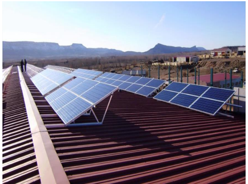
Figura 1.17 Estructura de soporte para instalaciones sobre techo
