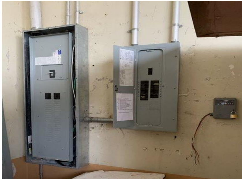
Figura J.34 Tablero General y Subtablero del Auditórium
