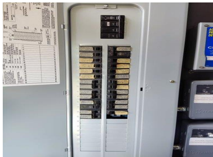
Figura J.5 Tablero General Edificio de Deportes
