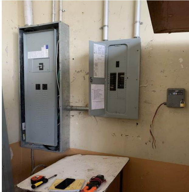
Figura J.33 Cuarto de inversores Auditórium
