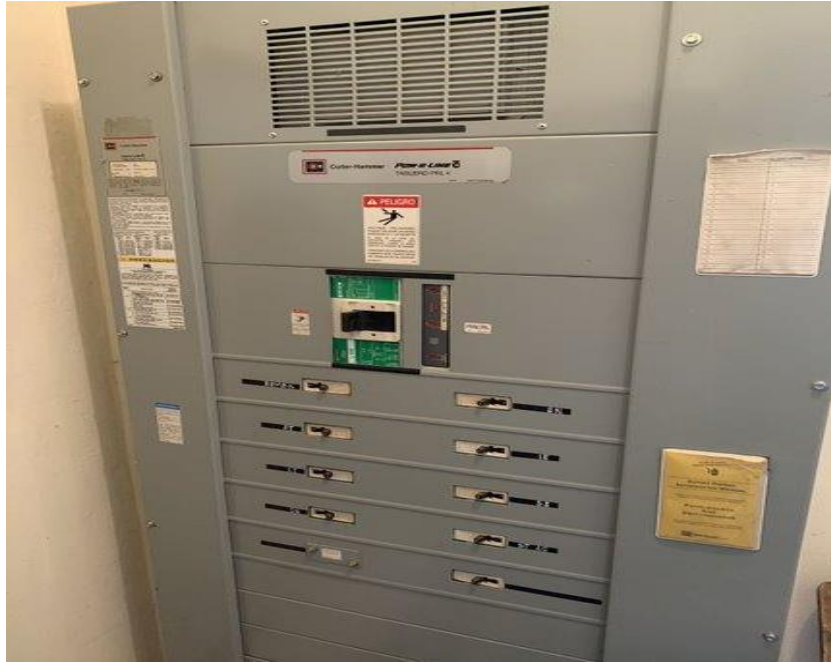
Figura J.18 Tablero General del edificio de medicina
