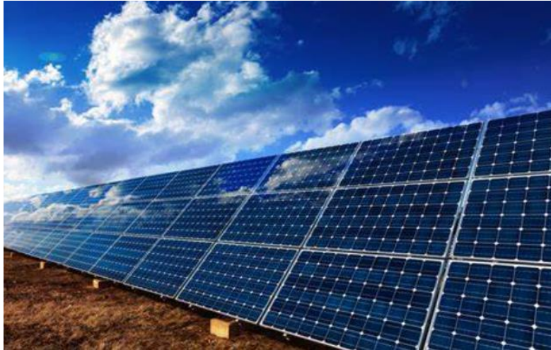
Figura 1.8 Energía solar fotovoltaica
