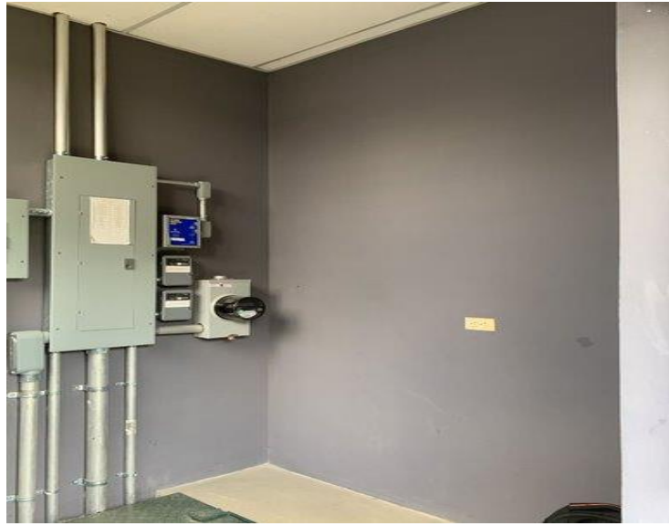
Figura J.4 Cuarto de Inversores Edificio de Deportes
