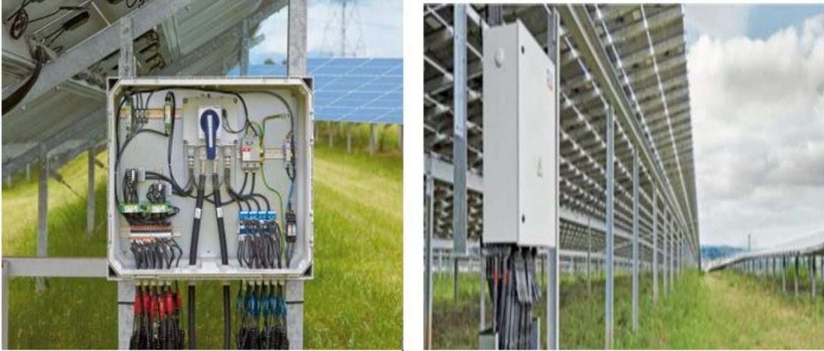
Figura 1.22 Combiner Box en sistemas Fotovoltaicos
