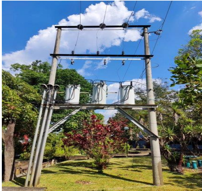
Figura J.12 Subestación que alimenta al edificio de usos múltiples
