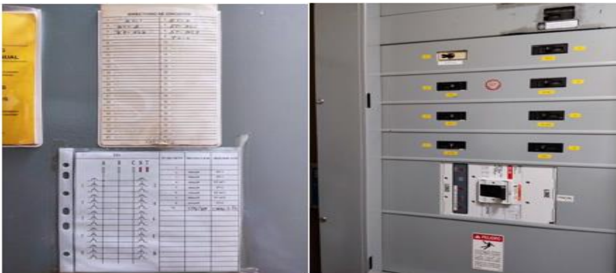
Figura J.11 Tablero General Edificio Usos Múltiples
