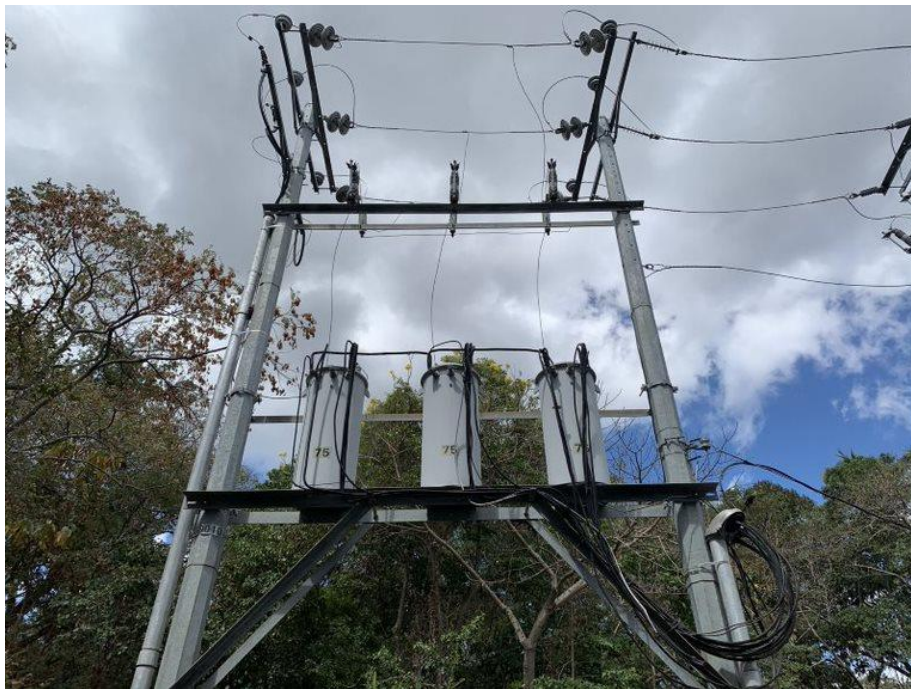
Figura J.19 Subestación que alimenta al edificio de medicina
