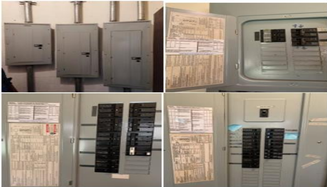
Figura J.20 Subtableros Primer Nivel edificio de Medicina
