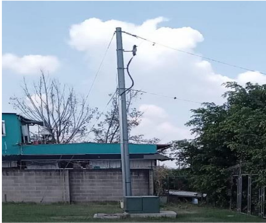
Figura J.6 Subestación que alimenta al Edificio de Deportes
