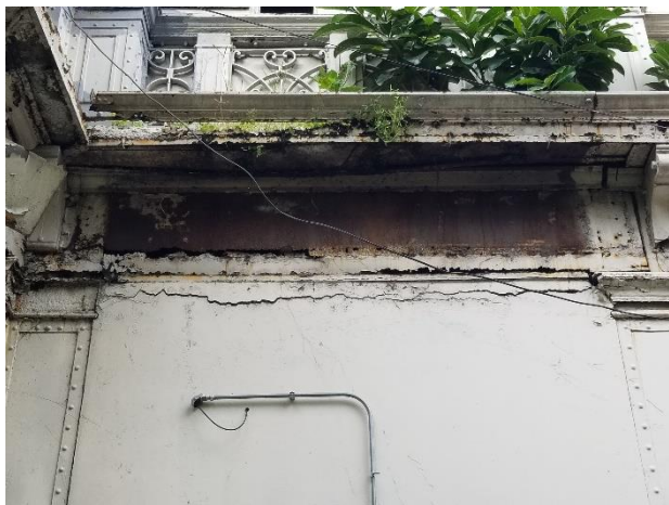
Fotografía 27. Fascia corroída por el óxido casi en su totalidad.
