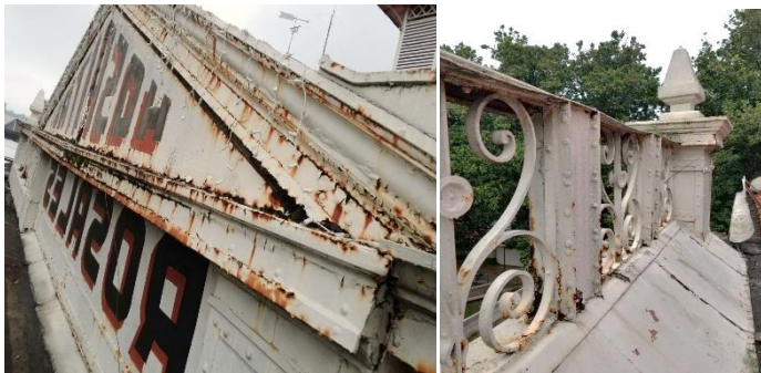
Fotografía 22. Corrosión y oxidación de elementos metálicos.
