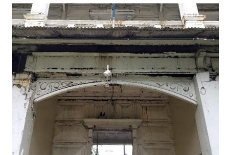
Fotografía 24. Desgaste de piezas en cornisa y fascia.
