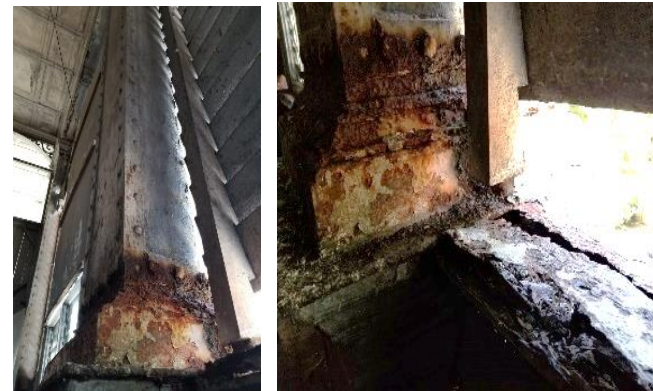
Fotografía 31. Columnas Internas, segundo nivel, corrosión, óxido y desprendimientos de materiales.
