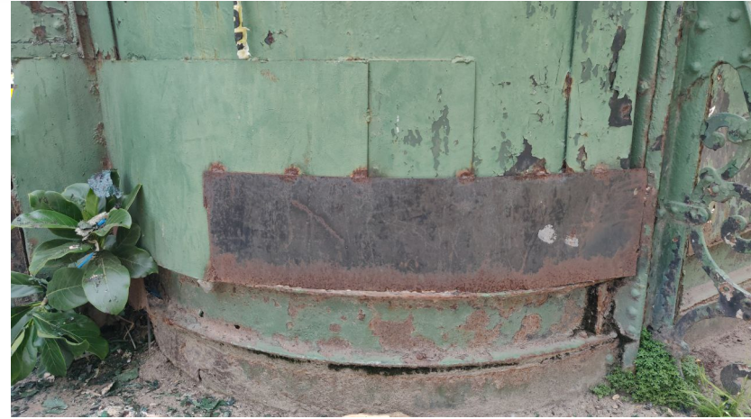
Foto 20 Láminas Añadidas a la Parte Inferior del Barandal.
