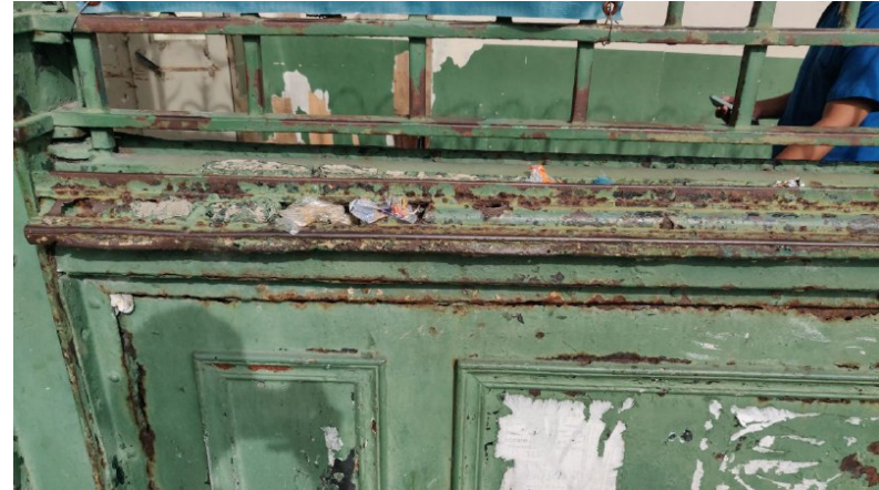
Foto 18 Parte Central Del Barandal Hospital Rosales
