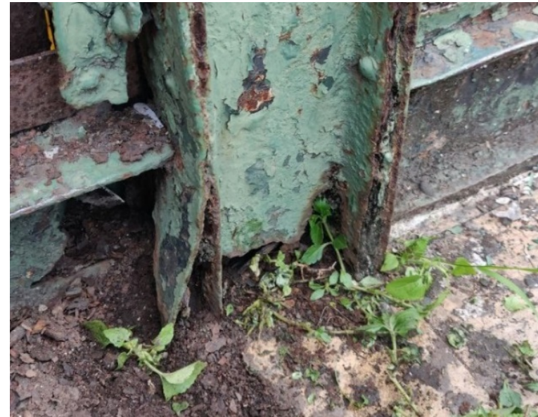
Foto 21 Estado General de la Base en Columnas
