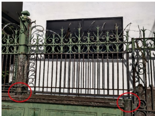
Foto 27 Columna Tramo #11 Cortada
