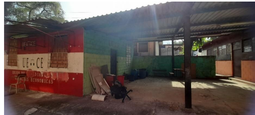
Imagen 33: Edificación en malas condiciones
