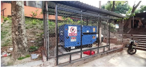
Imagen 17: Planta generadora de energía eléctrica
