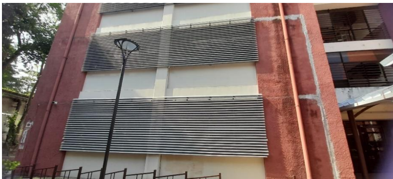
Imagen 28: Deterioro en edificio compartido.
