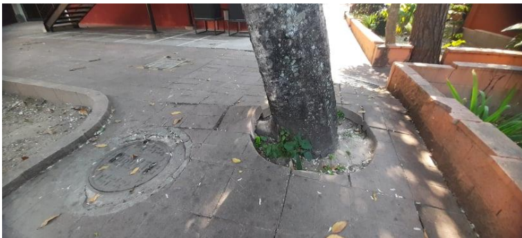
Imagen 4: Deterioro en circulaciones a causa raíces de árboles
