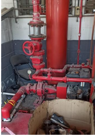
Ilustración 8. Sistema de bombeo contra incendios.
