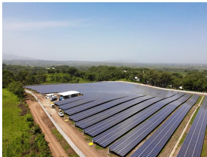
Figura 7. Parque de paneles FV, por AES El Salvador, San Juan Opico, El Salvador.
