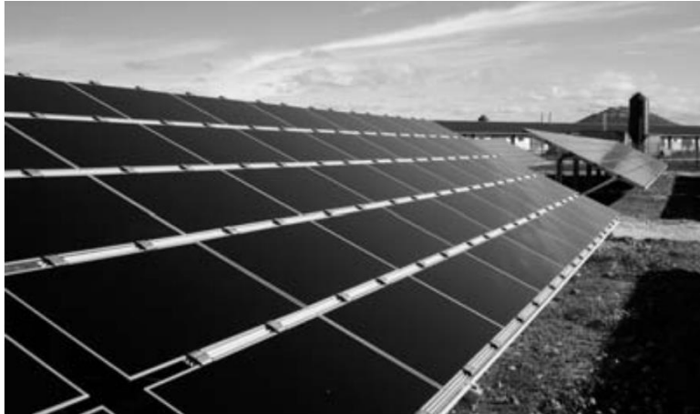
Figura 27. Vista parcial de una planta FV de 100kW de TeCd en Aragón
