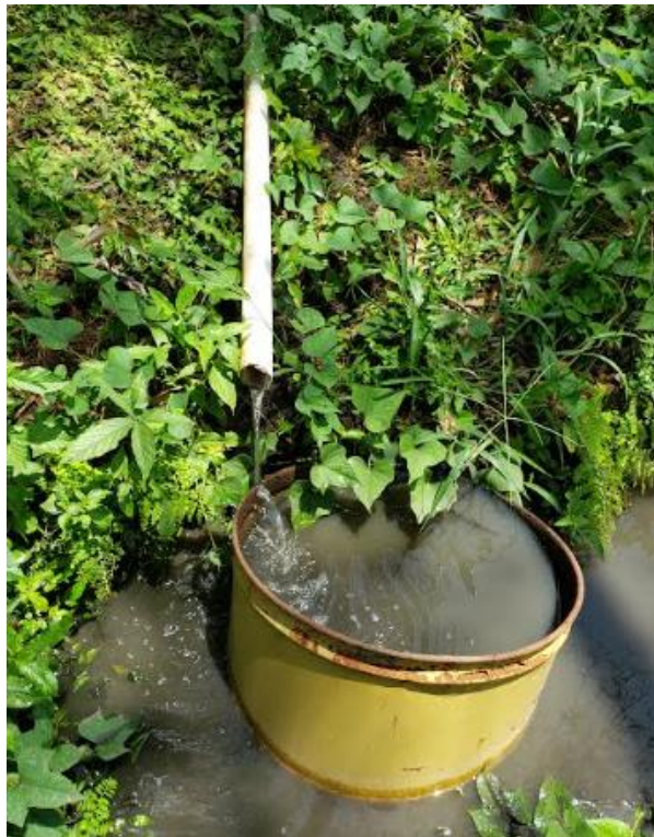
Figura 18. Etapa de vertido del agua tratada, etapa final del sistema de tratamiento de aguas residuales.
