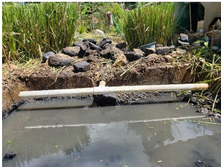
Figura 16. Distribuidor de entrada para aguas residuales.
