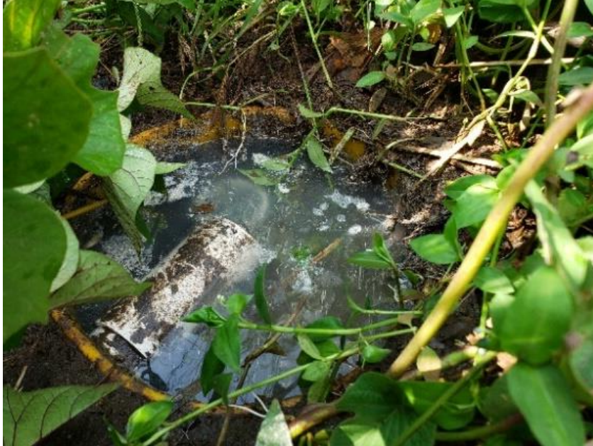
Figura 14. Condición de la trampa de grasa.
