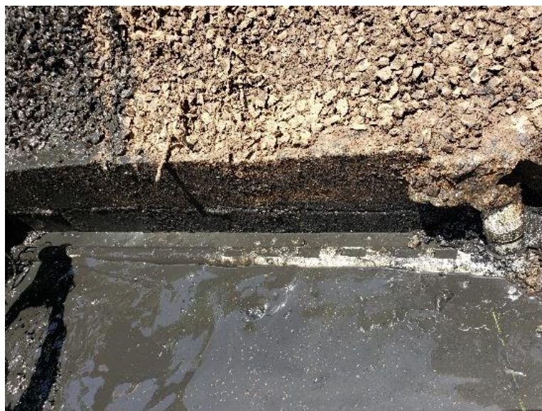
Figura 17. Sistema de drenaje de salida del humedal artificial.
