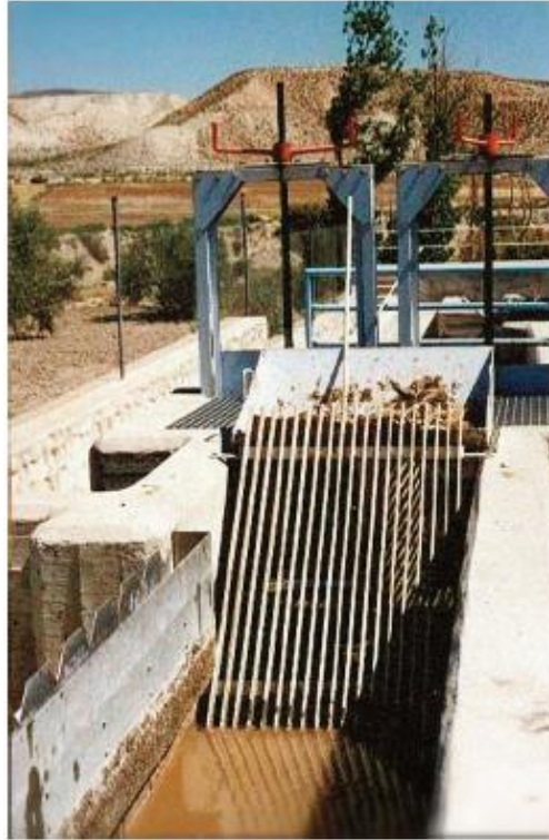
Figura 5. fotografía de una reja de desbaste de limpieza manual.
