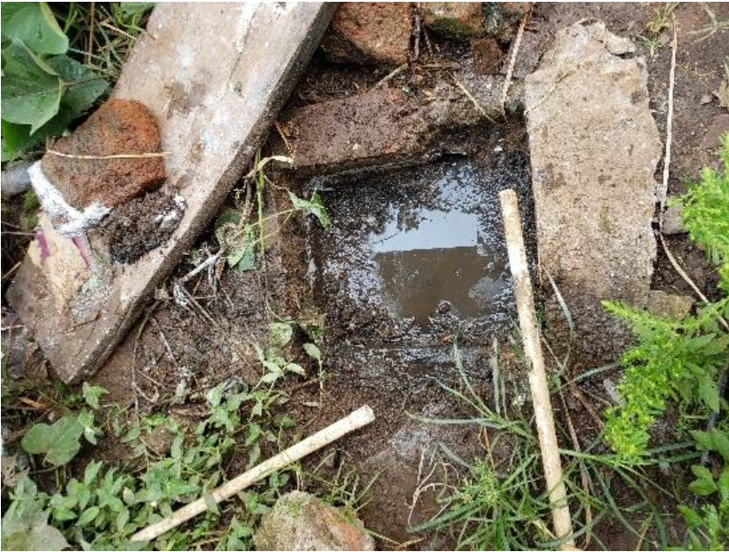
Anexo 5. Condición inicial de la caja de sedimentación
