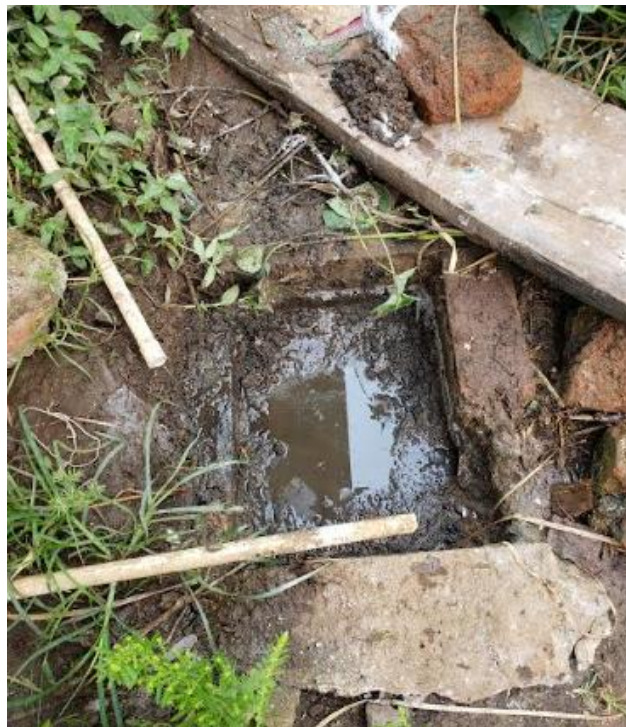
Figura 13. Condición de la caja de desbaste de gruesos antes de las actividades de recuperación del sistema.
