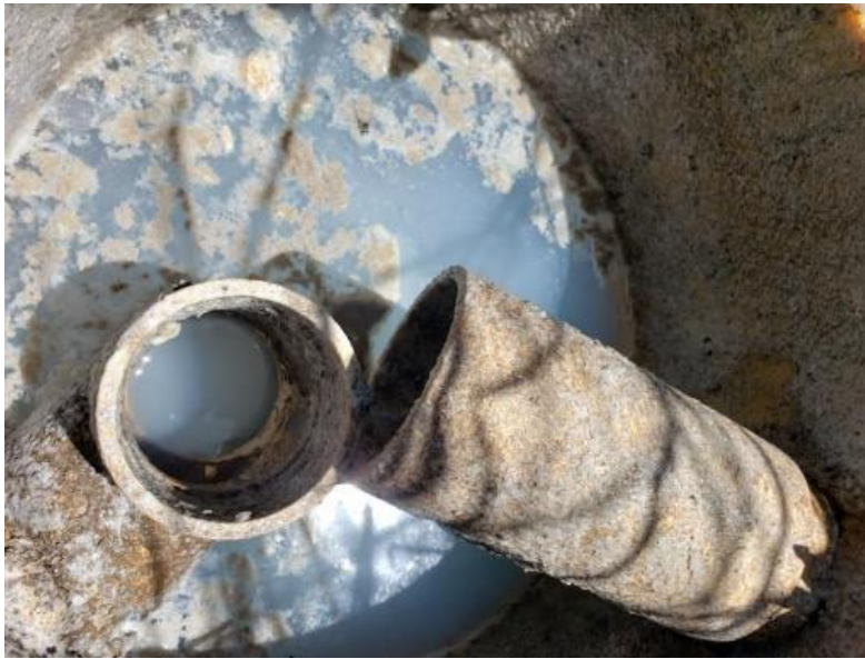
Anexo 17. Condiciones del agua que ingresa al Sistema de Tratamiento de Aguas Residuales por medio de la trampa de grasas.
