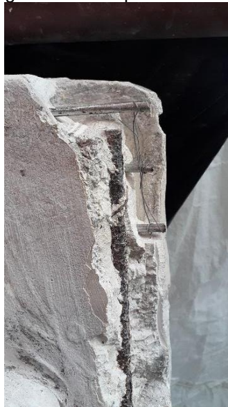
Figura 35. Detalle instalación de pines metálicos para refuerzo de material, lado derecho frontal del relieve.
