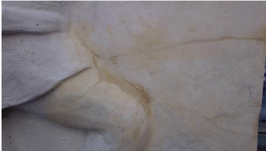
Figura 40. Detalle, resane de grieta vertical con pasta de yeso dentado, cara frontal del relieve. Fotografía tomada por: Ronny Pérez.
