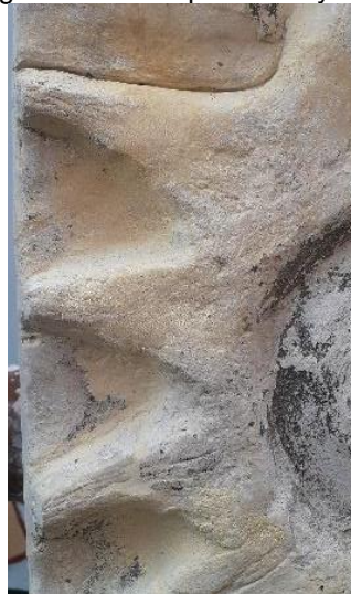
Figura 39. Detalle, resane de grieta vertical con pasta de yeso dentado, cara frontal del relieve.
