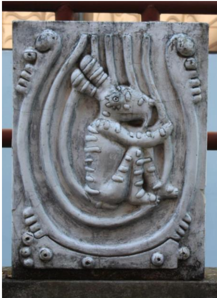
Figura 89: relieve N° 15, registro del estado físico encontrado, vista frontal 2022. Fotografía tomada por equipo gestor.
