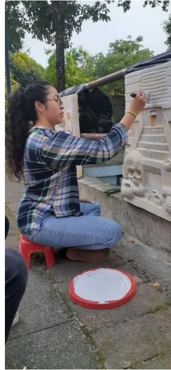
Figura 125: registro fotográfico, aplicación de impermeabilizante, vista \frac{3}{4} 2022. Tomada por el equipo gesto.
