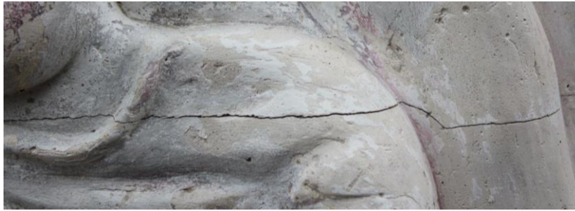
Figura 24. Detalle de grieta, lineal horizontal ubicada en cara frontal del relieve. Fotografía tomada por: Carlos Cubias.
