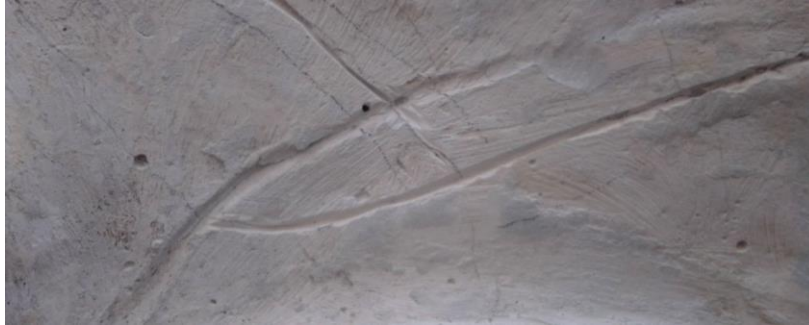
Figura 34. Detalle sisas de fisuras tratadas con herramienta rotativa Dremel, cara frontal de relieve.
