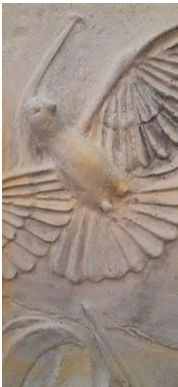
Figura 118: registro fotográfico, detalle de resanado, vista frontal 2022. Tomada por el equipo gestor.
