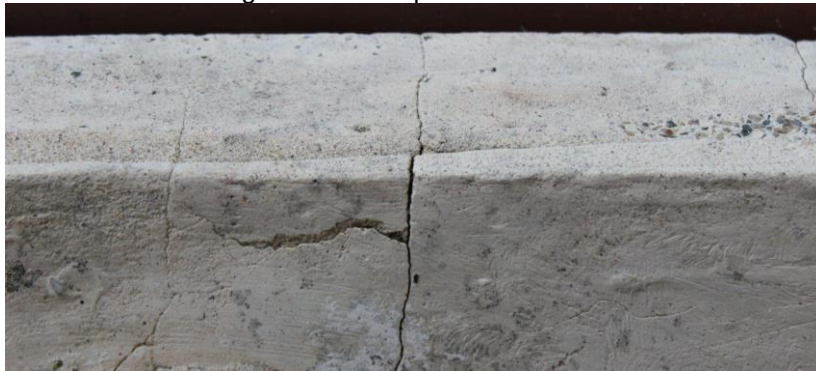
Figura 25. Detalle de grieta cruzada. ubicada al lado superior - frontal del relieve. Fotografía tomada por: Carlos Cubias.
