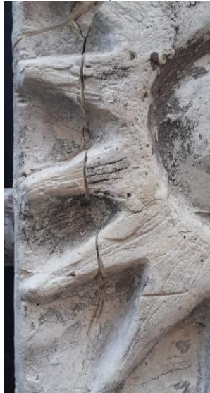
Figura 38. Detalle de grieta vertical cara frontal del relieve.
