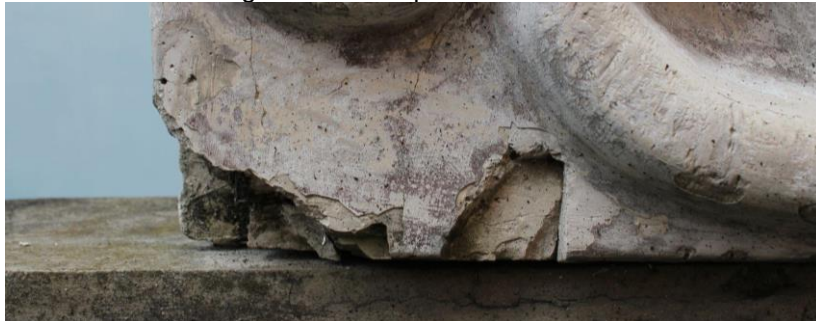
Figura 26. Desprendimiento de material, ubicado en cara frontal inferior del relieve. Fotografía tomada por: Carlos Cubias.
