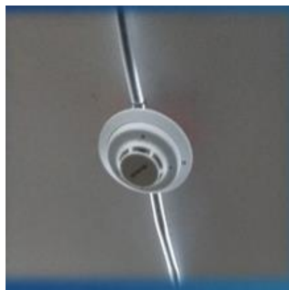
Fotografía 8: Sensor de humo y temperatura.
