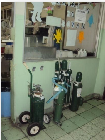
Tanques de oxígeno almacenados en pasillos sin protección.
