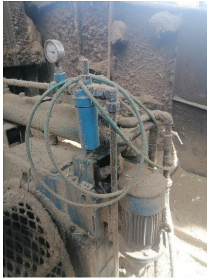
Figura 50. Salida de aire comprimido - Limpieza de equipos
