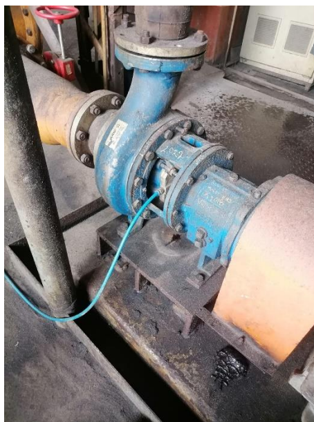
Figura 51. Refrigeración de bomba
