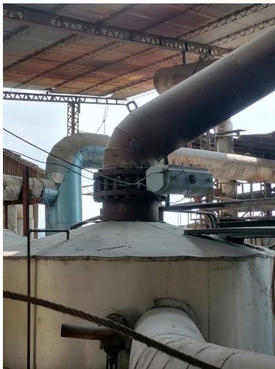
Figura 43. Actuador Bray para válvula de vapor de meladores de 18"
