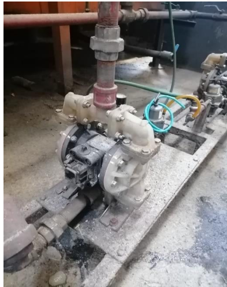
Figura 48. Bombas de diafragma para floculante
