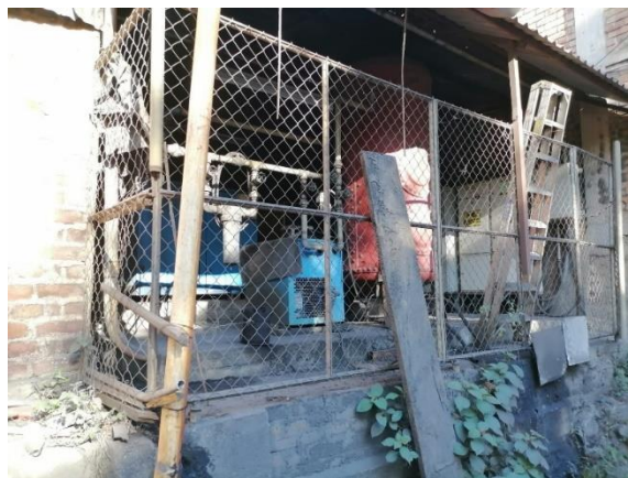
Figura 45. Sala de compresores
