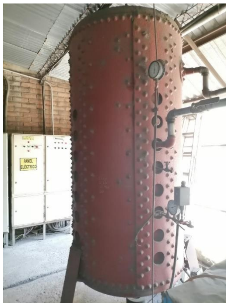
Figura 38. Tanque de almacenamiento
