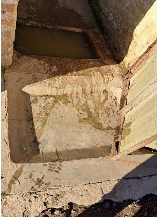
Figura 35. Pediluvios en mal estado y con agua sucia, sin ningún material de desinfección.
