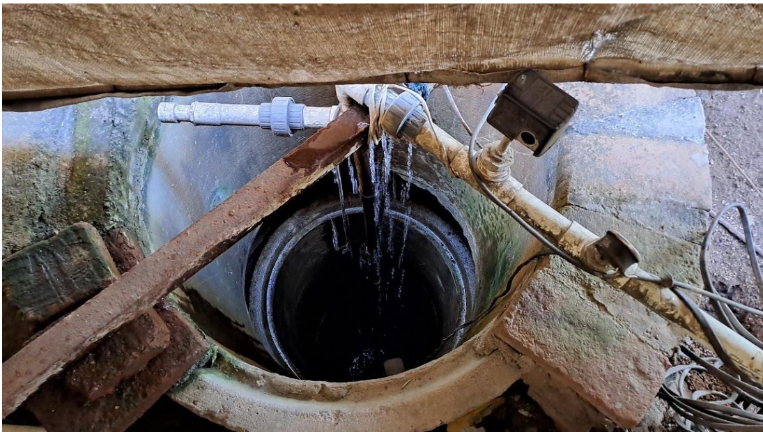
Figura 38. Pozo del cual se obtiene al gua para cerdas y lechones.
