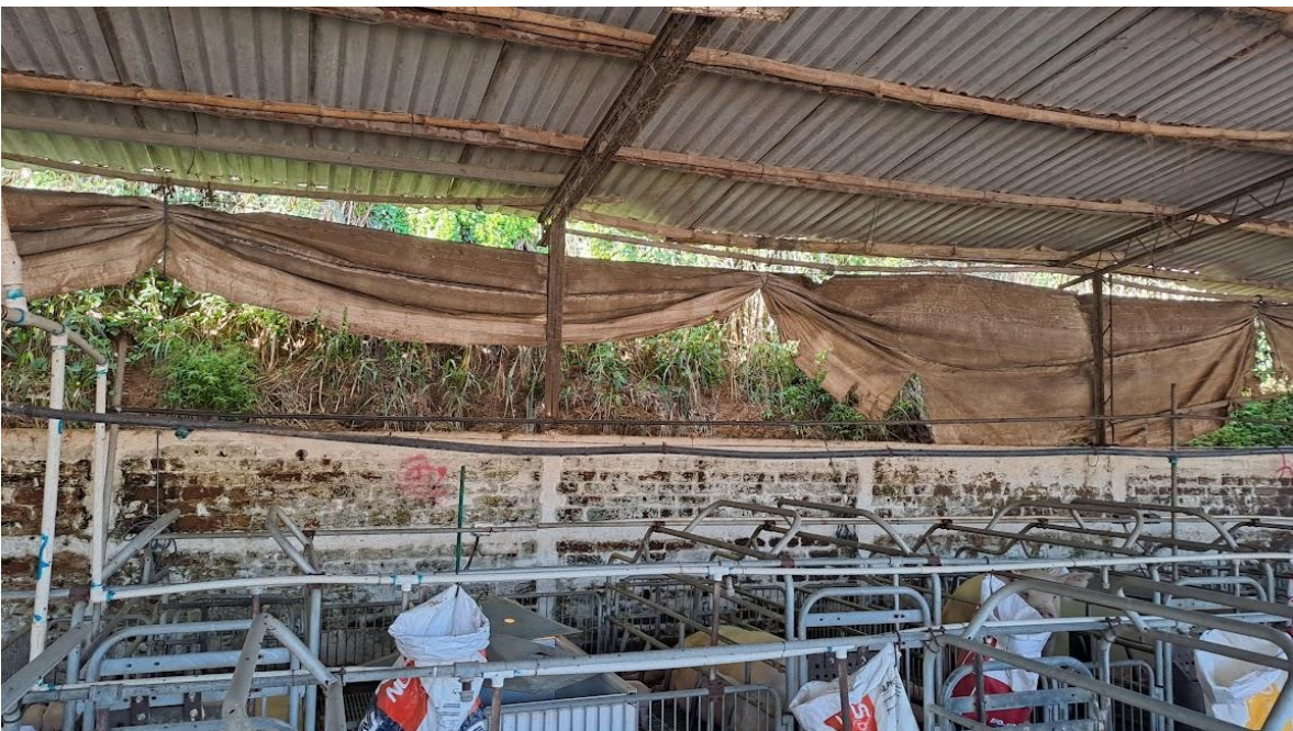
Figura 6. Deterioro de infraestructura y cortinas del área de maternidad.
