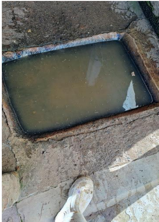
Figura 34. Pediluvios en mal estado y con agua sucia, sin ningún material de desinfección.
