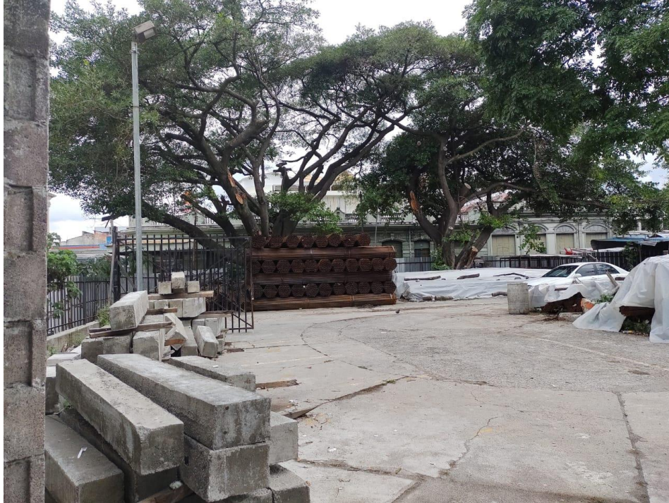
FUENTE: Equipo de trabajo C. E., Predio universitario en mal estado, donde se observan materiales de construcción apilados y un auto estacionado, San Salvador 24 de mayo 2022
