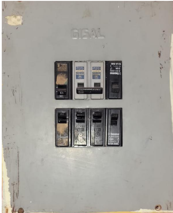
Ilustración 6: Interruptores termomagnéticos de 15,20, 40 y 50 amperios.
