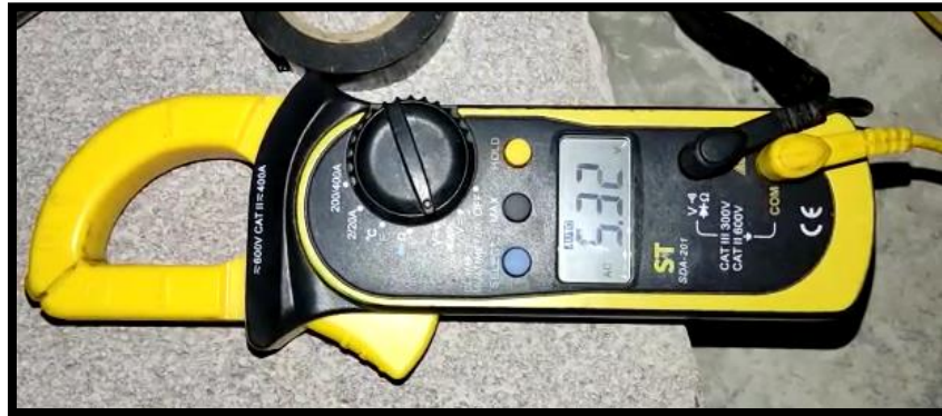
Figura 91 Conexión de VDF con transformador reductor a la salida para su respectiva toma de datos y señales.
