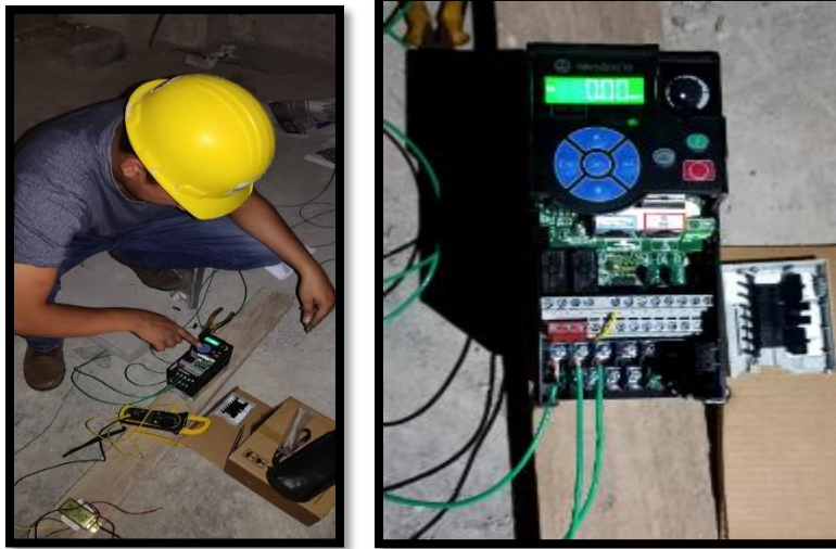
Figura 89 Conexión y parametrización del variador para iniciar marcha.
